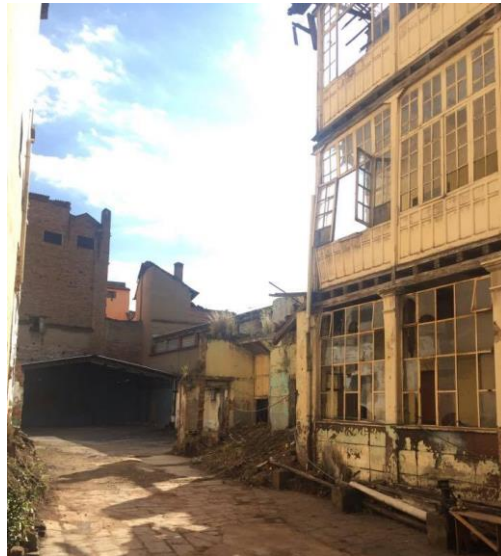
Fotografía 8: Casa abandonada barrio San Blas
