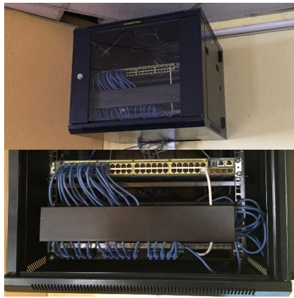
Figura 39. Rack del laboratorio de hombres de la Nueva extensión Universitaria. Fuente: Departamento de Sistemas UPSQ
