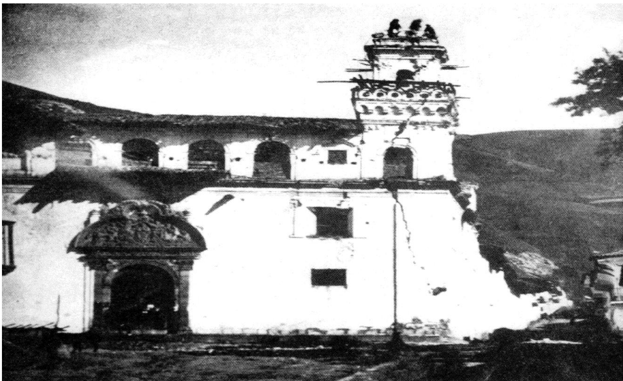
La Iglesia de Santa Clara cuarteada por el sismo del 16 de agosto de 1868. En esa oportunidad varias casas se cayeron y hubieron algunos muertos. La calle Rocafuerte era entonces un chaquiñán perfecto
