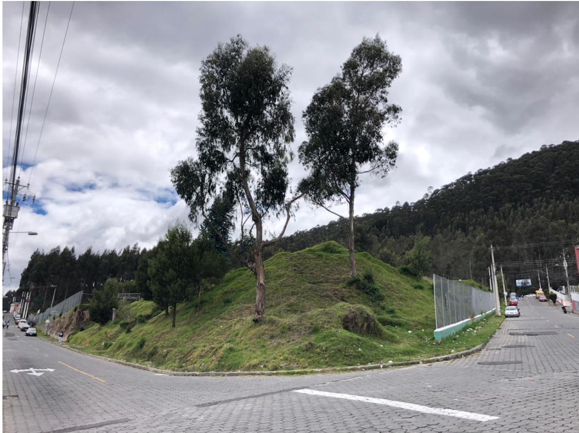
Figura 56: Talud deteriorado en la intersección de las calles Antonio Costas y Miguel Donoso. Fotografía de: Gabriel Troncoso
