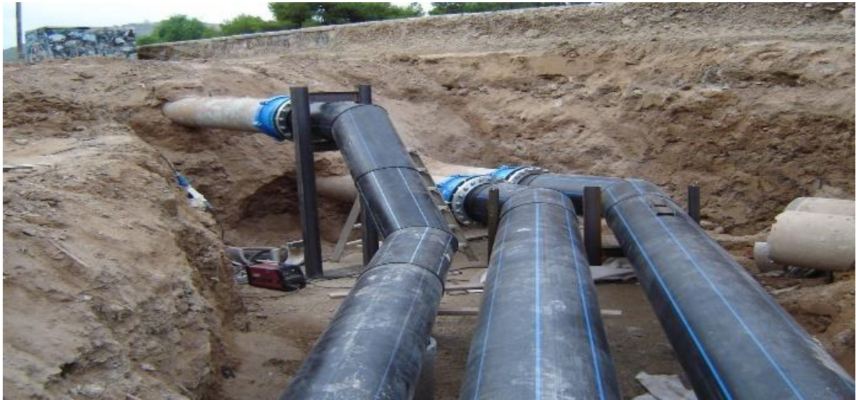
Figura 8: Tuberías de agua potable Fuente: (EPAA-AA, 2017)
