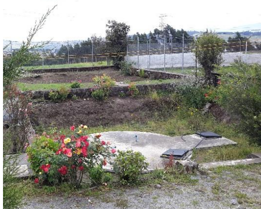
Figura No. 51 Tanque de cloración
