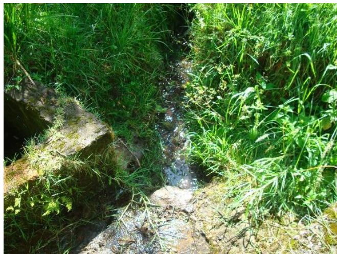
Figura No. 48 Fuga de agua en la caja de carga
