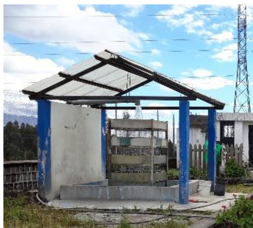
Figura No. 49 Camas de aireación de agua cruda
