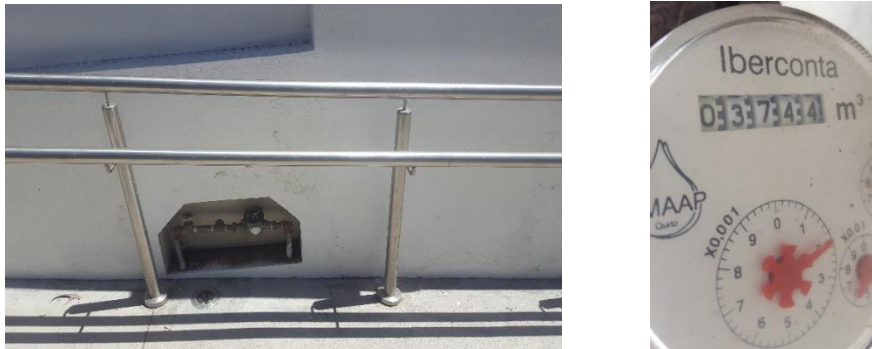
Figura 35. Medidor Secundario de Agua Potable
