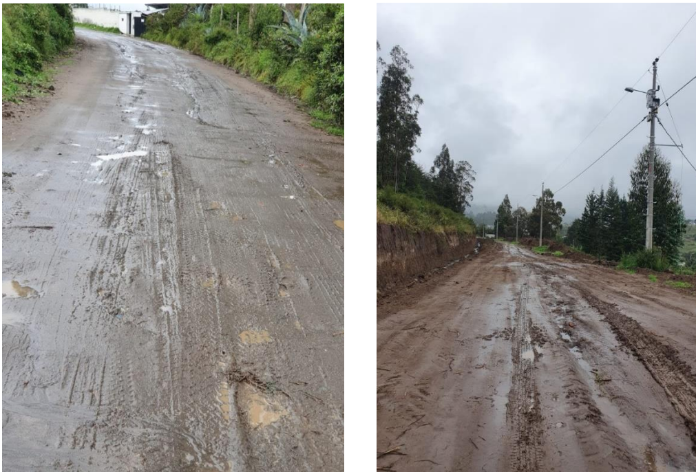
Ilustración 54 Vías inventariados en 2023 inundadas – Cayambe Fase 1 (Elaboración propia)
