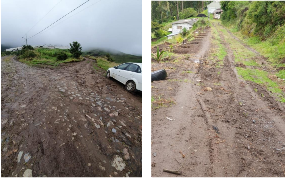
Ilustración 53 Vías inventariados en 2023 en mal estado – Cayambe Fase 1 (Elaboración propia)
