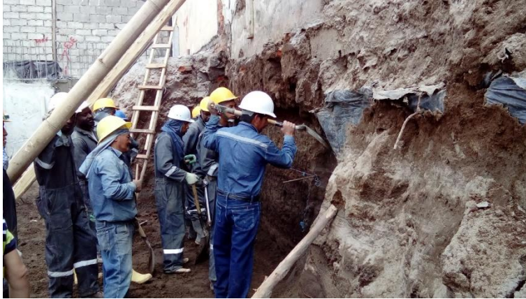
RIESGOS EN ETAPAS: 1 APERTURA MANUAL
