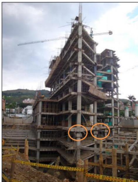
Figura 14. Aislador instalado en piso intermedio
