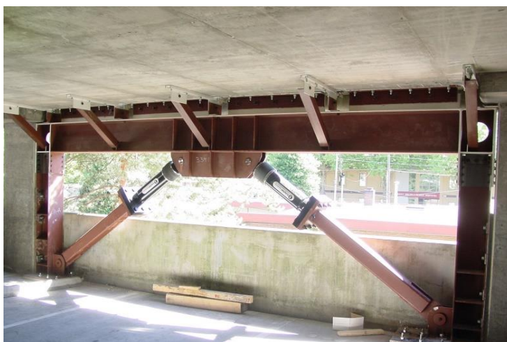
Figura 20. Amortiguador tipo Taylor instalado en arriostramiento excéntrico
