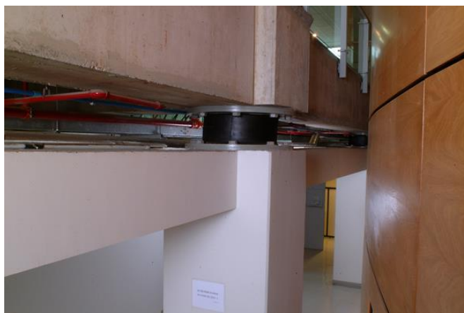
Figura 15. Detalle de aislador instalado en piso intermedio
