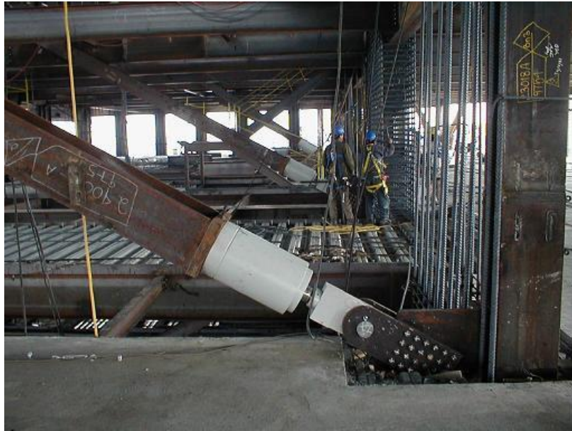
Figura 116. Amortiguador viscoso tipo Taylor instalado en diagonal metálica
