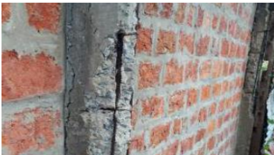
Figura 14: Acero corroído por sulfatos en la parroquia Simón Bolívar.
