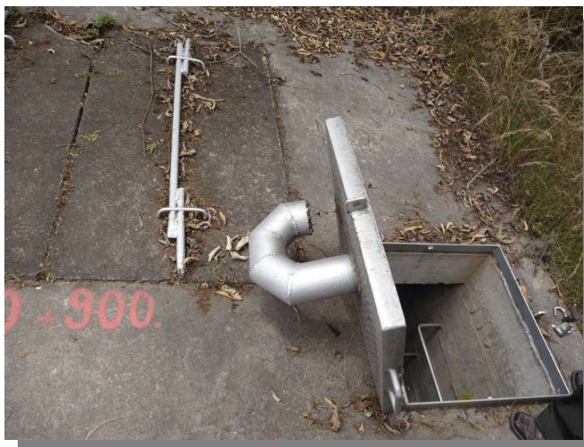
Fotografía 11. Cámara de la válvula de desfogue abscisa 40+900
