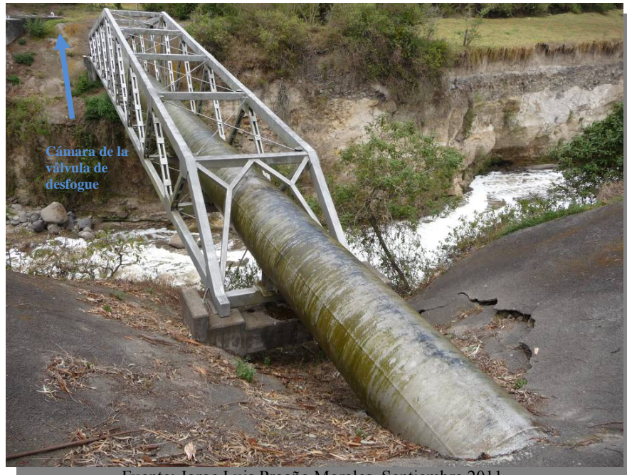
Fotografía 13. Cámara de la válvula de desfogue y paso elevado abscisa 43+500
