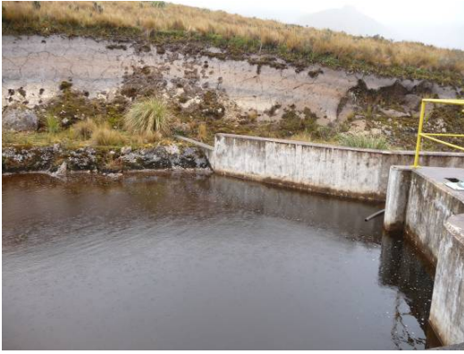
Captación Quillugsha3, deslizamiento
