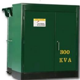
Figura 23. Transformador tipo pedestal (13,8 KV/220V) 300 KVA.
