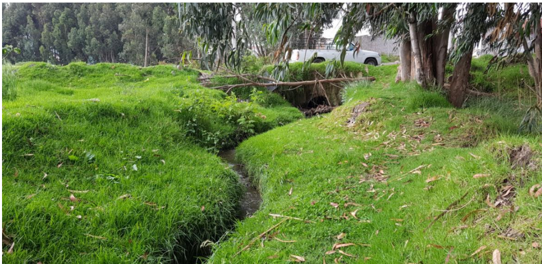
Imagen 17. Tubería que actúa como puente en el Punto 10 (Autor, 2023)
