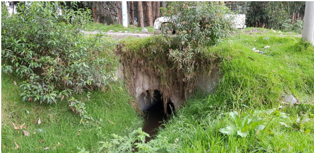
Imagen 19: Nodo 10, tubería que hace pasar el agua de la quebrada (Autor, 2023)
