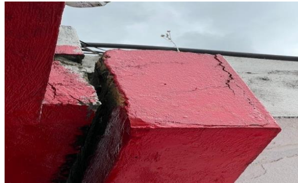
Agrietamiento en las vigas
