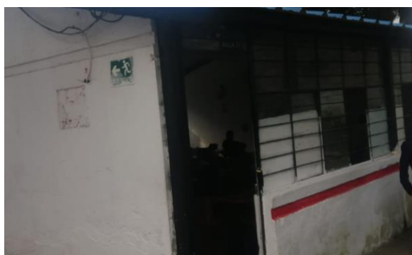
Humedad y agrietamiento en la mampostería.
