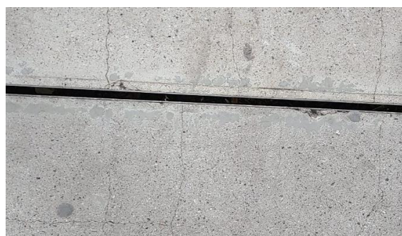
Planchas prefabricadas agrietadas y juntas muy abiertas.
