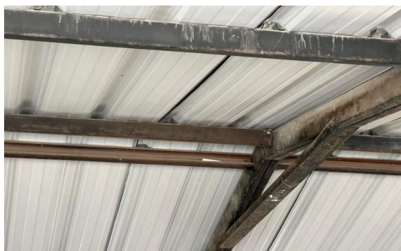
Cercha de acero con presencia de oxido.
