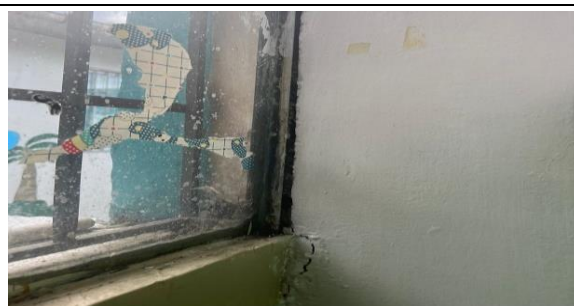
Grietas en la mampostería cerca de ventanas
