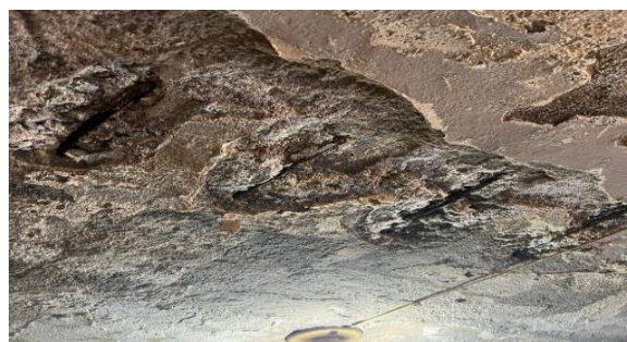
Aceros en vigas y columnas expuestos y corroídos
