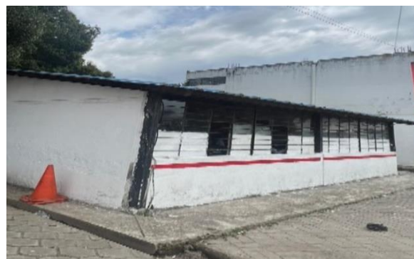
Perfil de acero con oxido en la parte externa.
