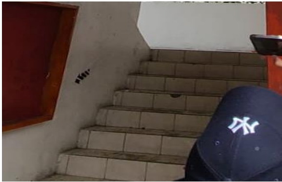
Escaleras sin cinta de seguridad
