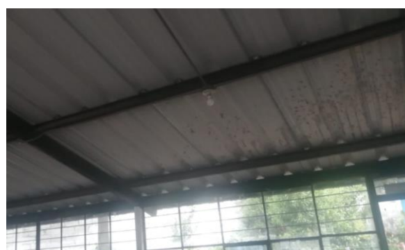
Desgaste y oxido en las planchas de zinc.
