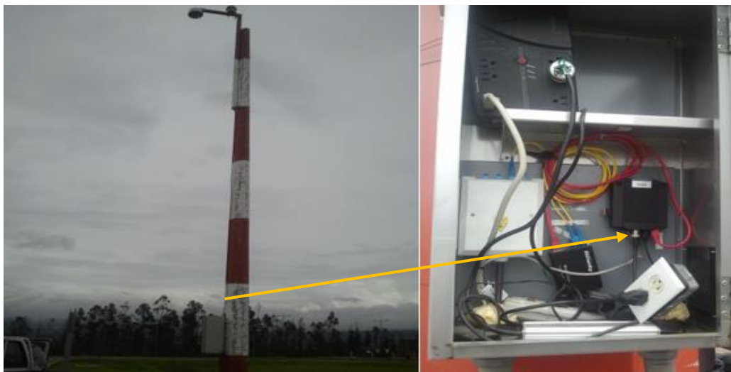
Figura N° 51. Cámara Analógica en la pista del AIMS.
