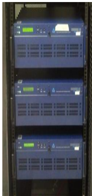
Figura N° 49. NVR Sistema GENETEC.
