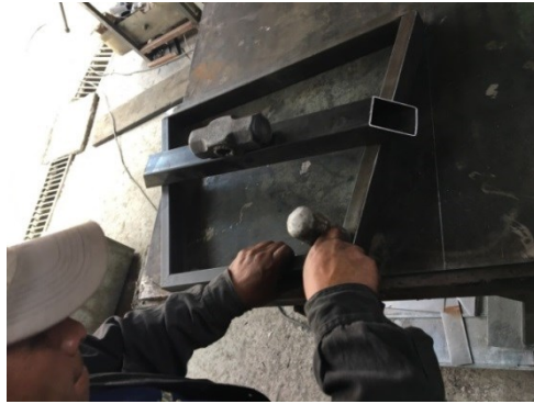
FIGURA N.- 56: Tubo de acero estructural. Perfil de banca. Por Diego Guevara. 2017.
