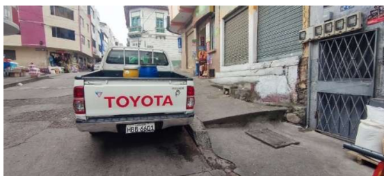
Figura 18. Fotografía de los escalones en la acera del tramo T3.
