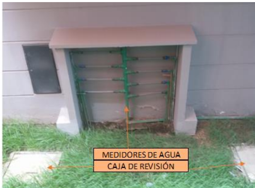
Figura 5. 15: Medidores de agua y pozos de revisión del bloque 1 de la manzana 12.
