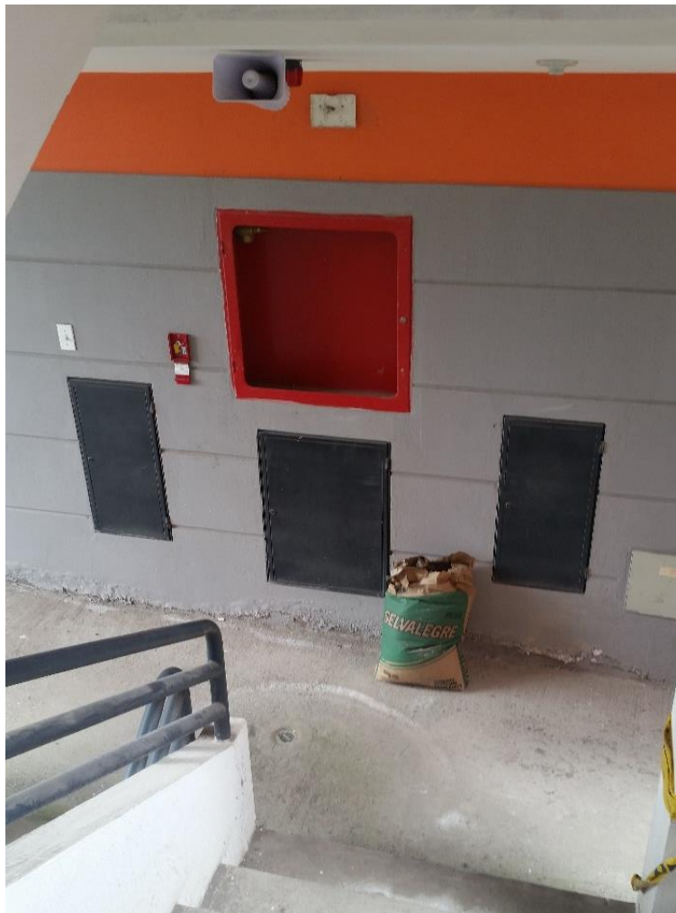
Ilustración 5. 6: Instalaciones Contra Incendios.
