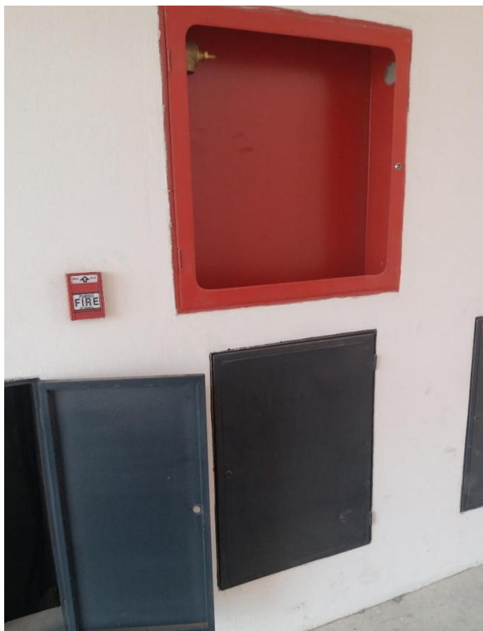
Ilustración 5. 7: Gabinete Contra Incendios, Manzana 12.
