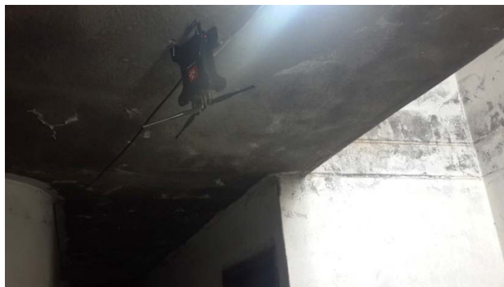
Figura 61. Router 3bumen ubicado en centro de la casa del segundo piso
