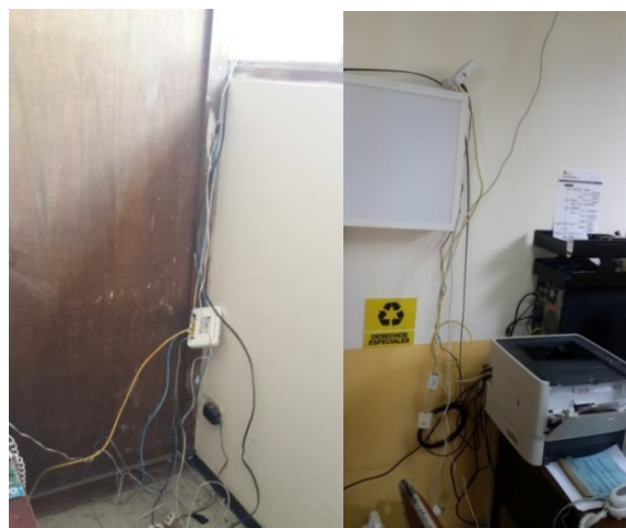
Figura 53. Instalación del ISP de la red del internet y telefonía Fuente: autor
