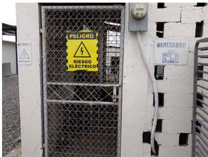
Figura 11. – Área eléctrica de alta tensión (Propia del autor)
