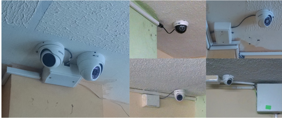
Figura 14: Distribución de cámaras de vigilancia en el interior
