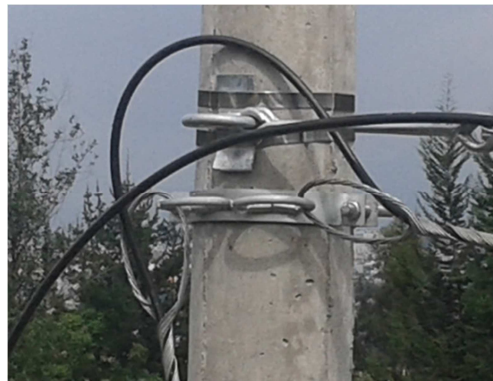
Figura 2.42: Cable de fibra con radio de curvatura demasiado cerrado
