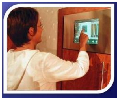
Figura 3.18: Operación de la Unidad de Control Domótico.
