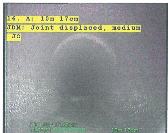
Foto: 151231_1107A-CDAJARDIN.jpg 10,17m, Junta desplazada mediana / Ninguna, dentro de los parámetros admisibles
