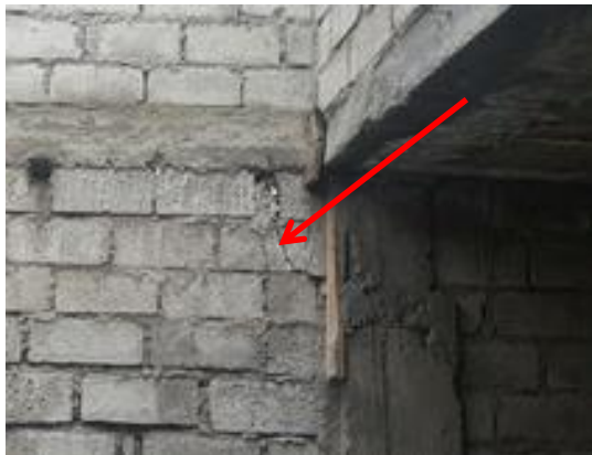
Imagen 21: Fisuramiento de bloque Fuente: Propia
