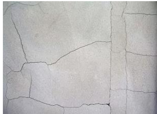
Imagen 26: Fisuramiento por mala fase de curado Fuente: Propia
