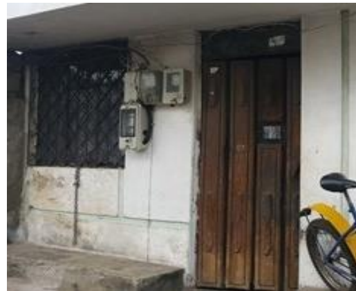
Imagen 30: Puertas de material mixto Fuente: Propia
