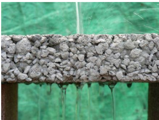
Imagen 27: Hormigón poroso por mala vibración Fuente: Google
