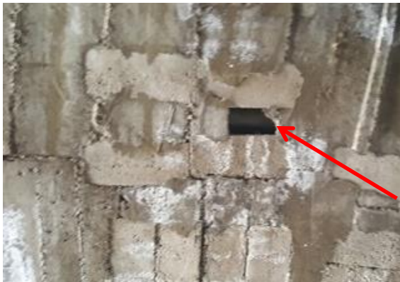
Imagen 25: Espacios por mala fundición en losas Fuente: Propia
