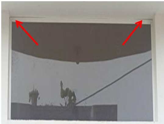
Imagen 29: Juntas mal selladas en ventanas Fuente: Propia
