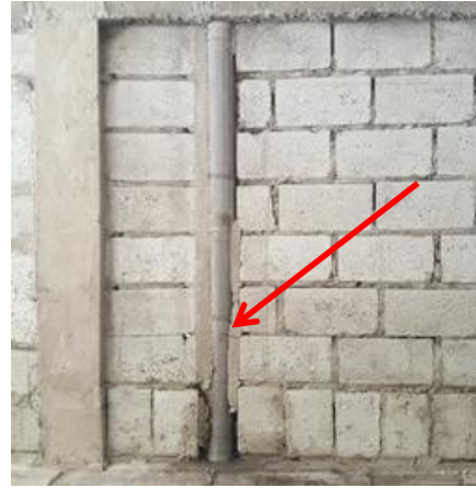
Imagen 20: Instalaciones en paredes Fuente: Propia
