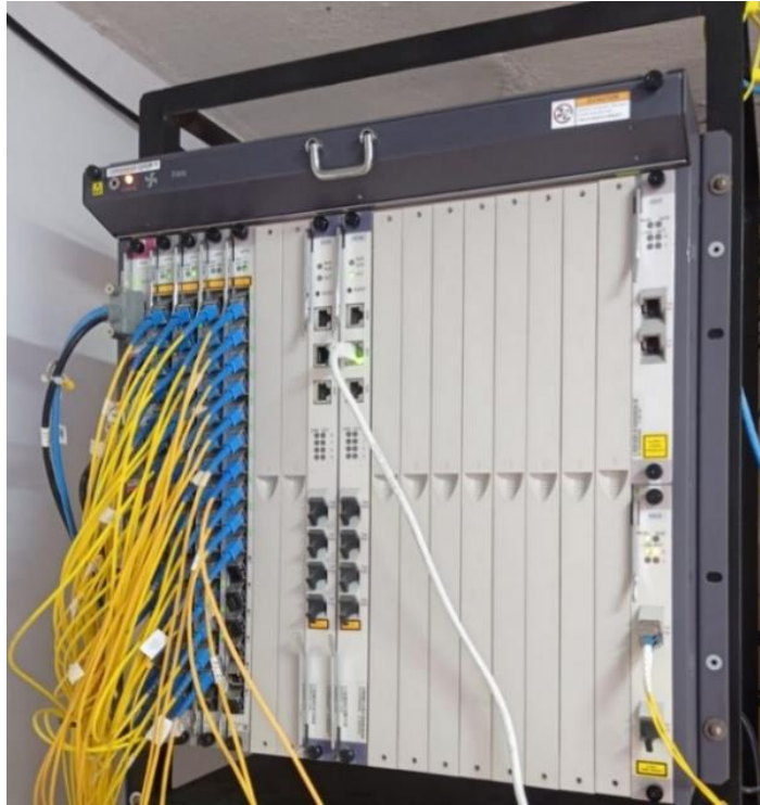
Figura 9. OLT activa en un cuarto de equipos.
