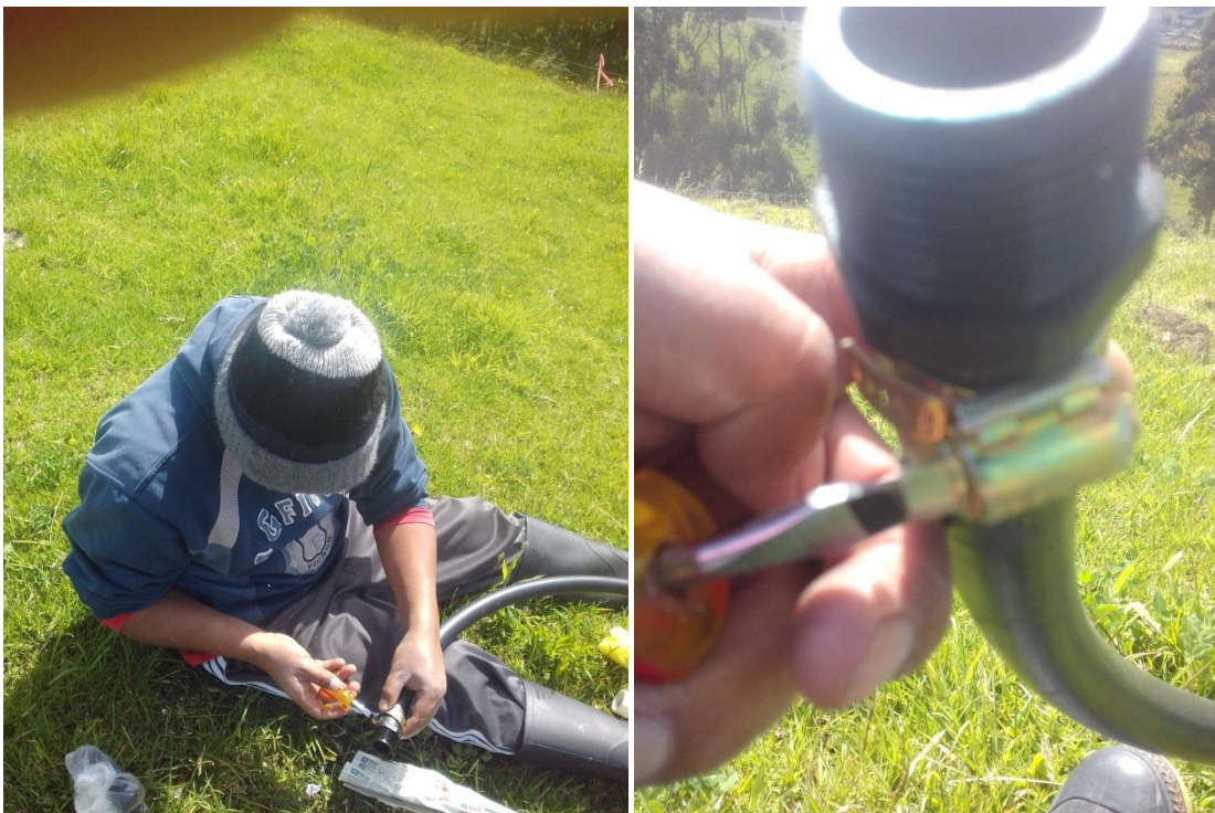
Fotografía 16: Evidencia de instalación de manguera nueva y sus accesorio.
