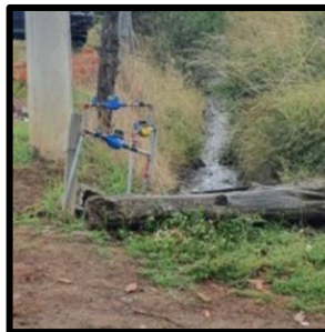
Ilustración 6. Medidor instalado en el barrio la Paz
