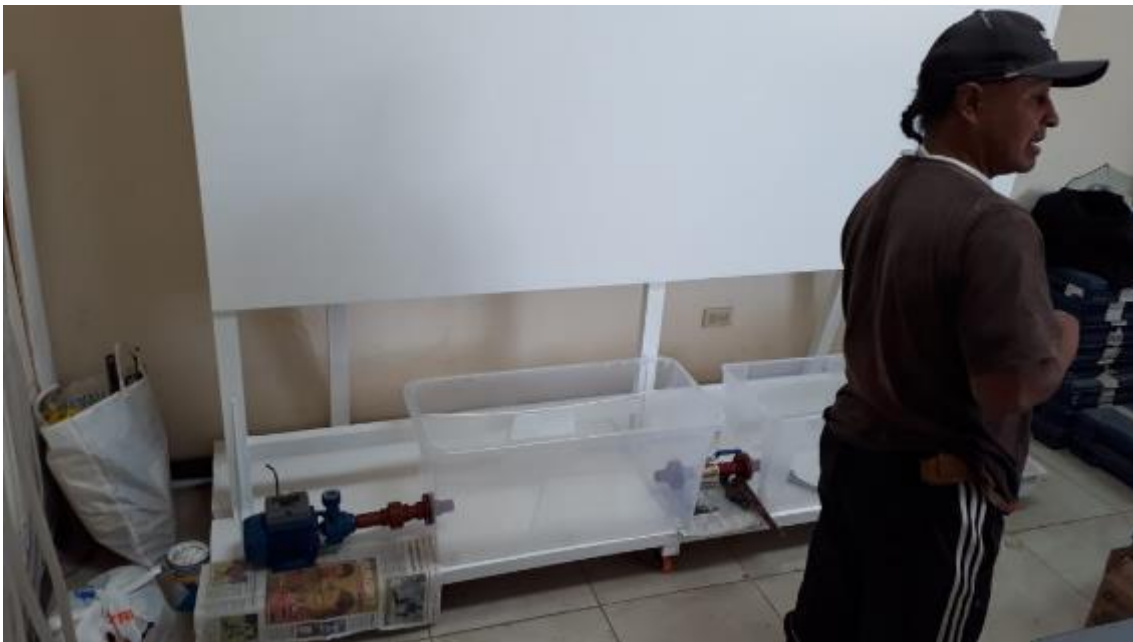
Fotografía 6. Unión tanques y bomba. (Fuente: Fotografía de Paula Jaramillo y Jack Vásquez)
