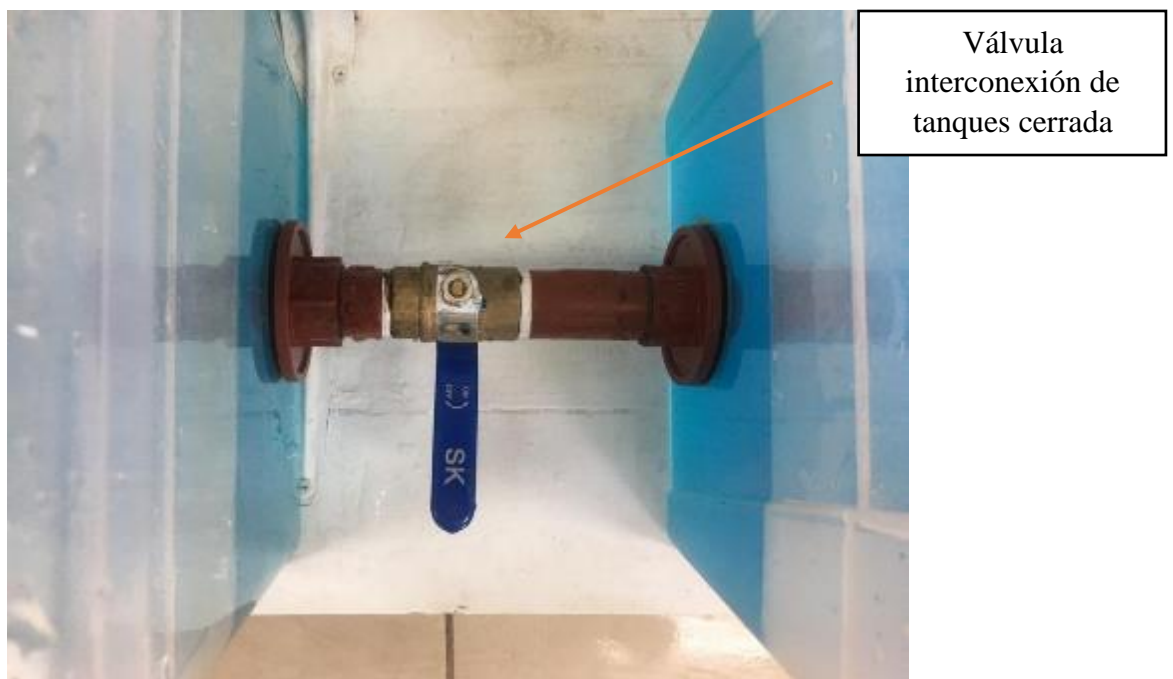
Fotografía 35. Válvula de interconexión de tanques. (Fuente: Fotografía de Paula Jaramillo y Jack Vásquez)
