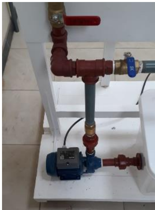
Fotografía 8. Bomba, tubería y accesorios. (Fuente: Fotografía de Paula Jaramillo y Jack Vásquez)
