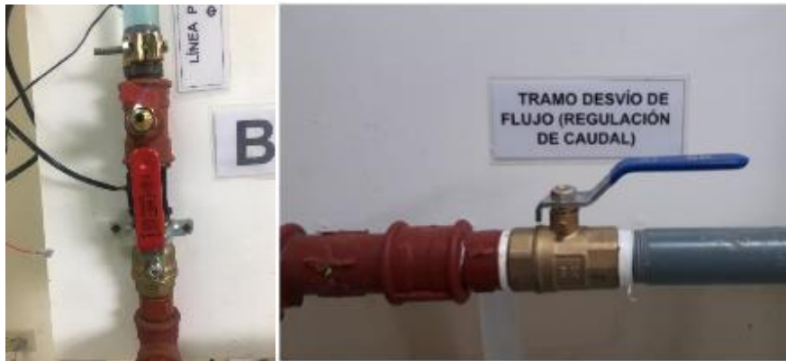
Fotografía 77. Válvula de regulación de caudal y línea principal. (Fuente: Fotografía de Paula Jaramillo y Jack Vásquez)
