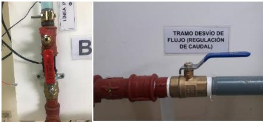
Fotografía 42. Válvula de regulación de caudal y línea principal. (Fuente: Fotografía de Paula Jaramillo y Jack Vásquez)
