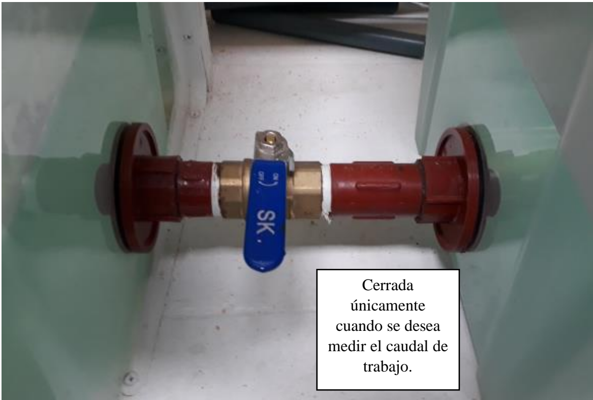
Fotografía 63. Válvula de interconexión de tanques cerrada. (Fuente: Fotografía de Paula Jaramillo y Jack Vásquez)
