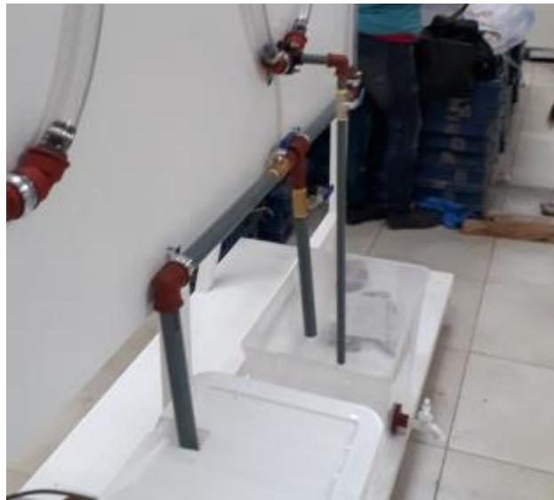
Fotografía 21. Tuberías y accesorios purga. (Fuente: Fotografía de Paula Jaramillo y Jack Vásquez)
