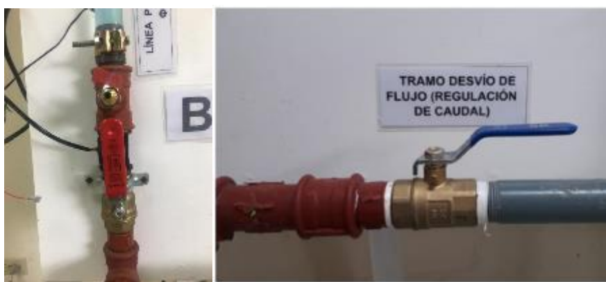
Fotografía 58. Válvula de regulación de caudal y línea principal. (Fuente: Fotografía de Paula Jaramillo y Jack Vásquez)
