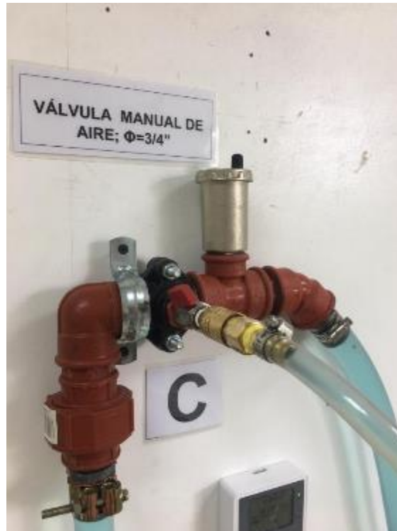
Fotografía 38. Válvula de medición de presión. (Fuente: Fotografía de Paula Jaramillo y Jack Vásquez)
