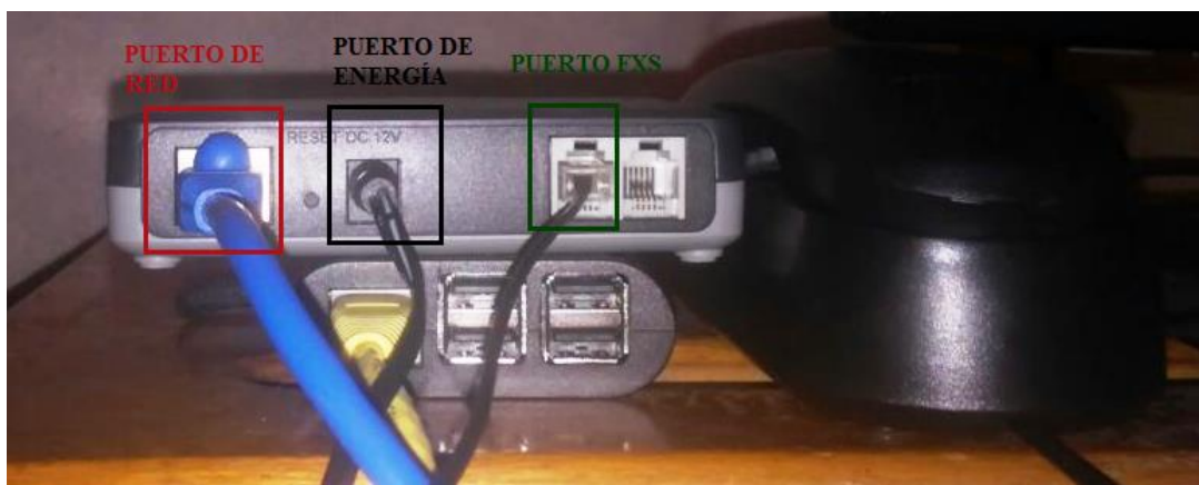
Fig. 5-39 Conexión del equipo Grandstream HT702
