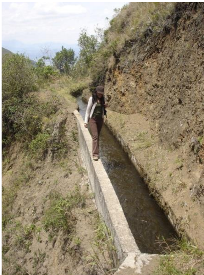
Foto No.13 Tramo en cemento, evidencia actual
