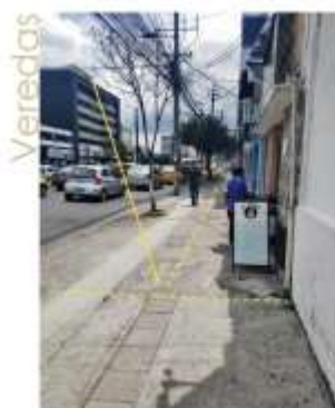
El podotáctil llega a un límite de circulación en infraestructuras.
