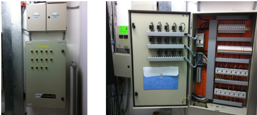
Figura 20: Tableros de control de iluminación
