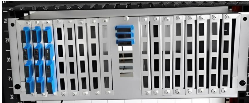
Figura 16 ODFS (Distribuidor de splitters ópticos)
