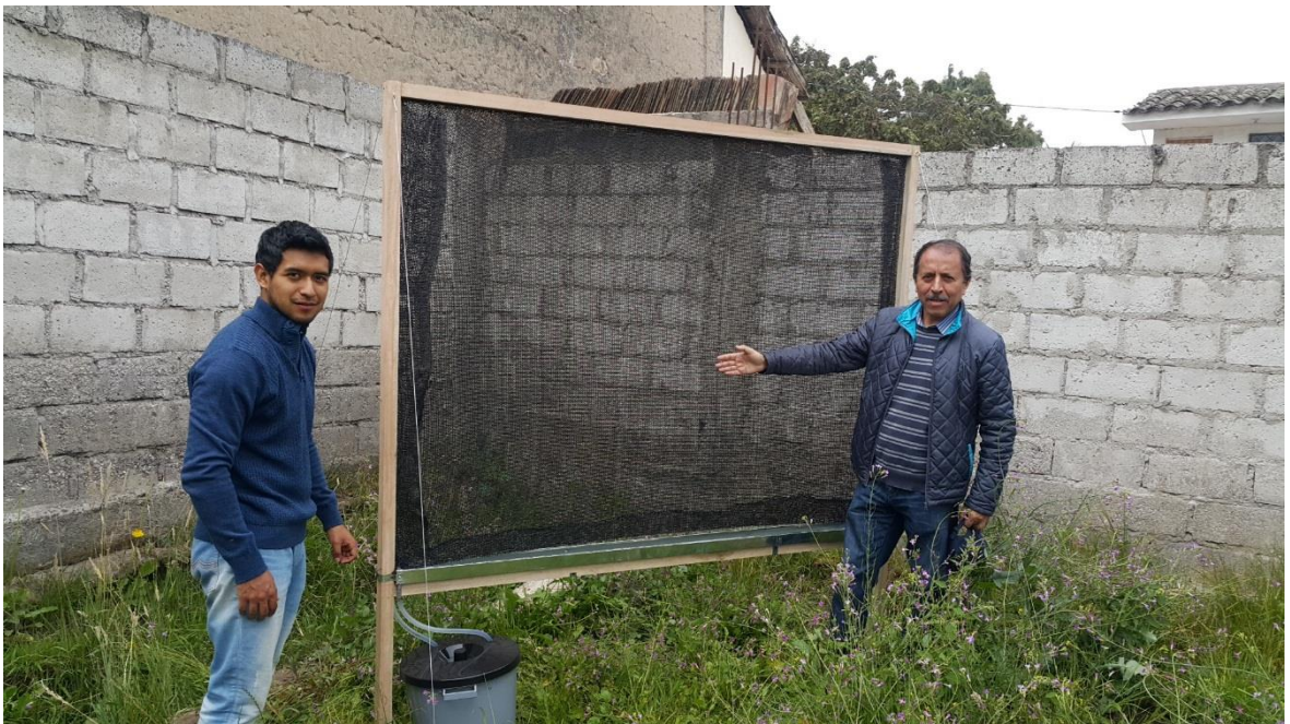
Fotografía 2: Instalación de Neblinómetros.
