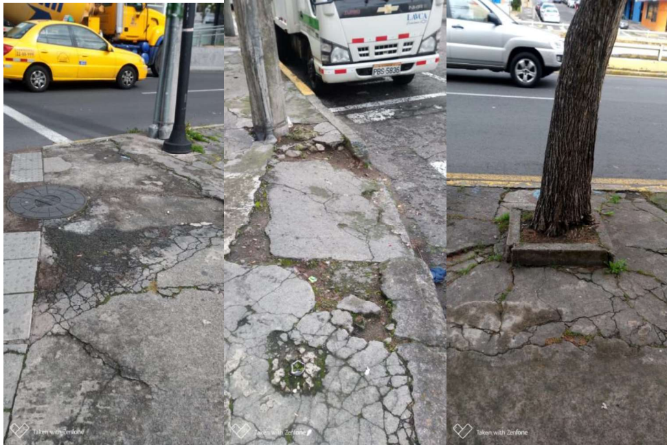
Imagen 23. Fotografía del estado de las aceras del área de estudio, calle 10 de Agosto.
