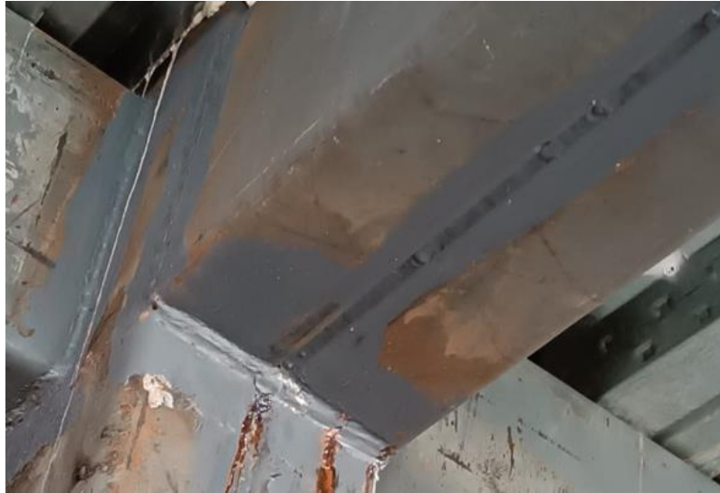
Figura 111 Poros en la soldadura longitudinal de viga tipo cajón
