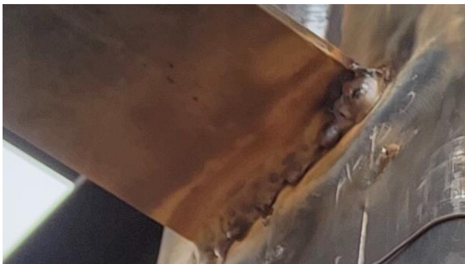
Figura 110 Discontinuidad del cordón
