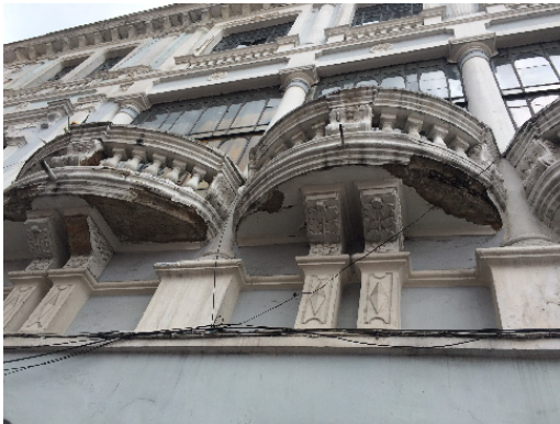
Daño en estructuras
