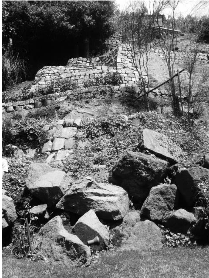
Figura 6: Fotografía del muro de piedra de la casa de Francisco Ursua (Torres L.,2015).
