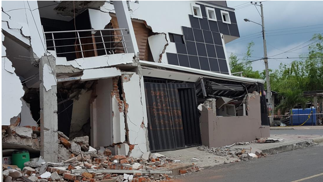
Ilustración 4: Daños en las viviendas
