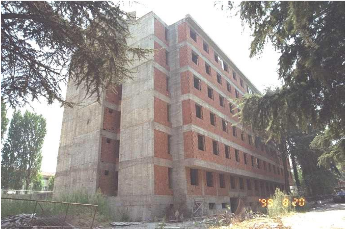
Foto 7.5: Edificio de marco de concreto reforzado, con paredes de corte, enladrillado en lleno múltiple. Terremoto Izmit (Kocaeli), Turquía, 17, 1999, magnitud 7.4.
