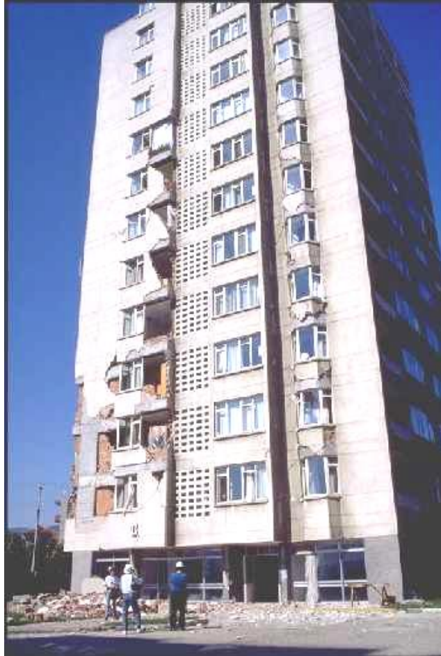
Foto 6.14: Daños estructurales menores. Terremoto de Izmit (Kocaeli), Turquía, de magnitud 7.4, Agosto 17 de 1999.
