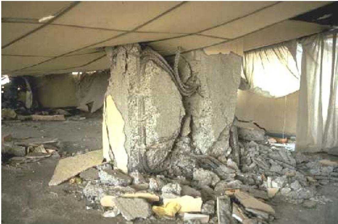
Foto 6.22: Columna que falló por excesiva excentricidad de masa.
