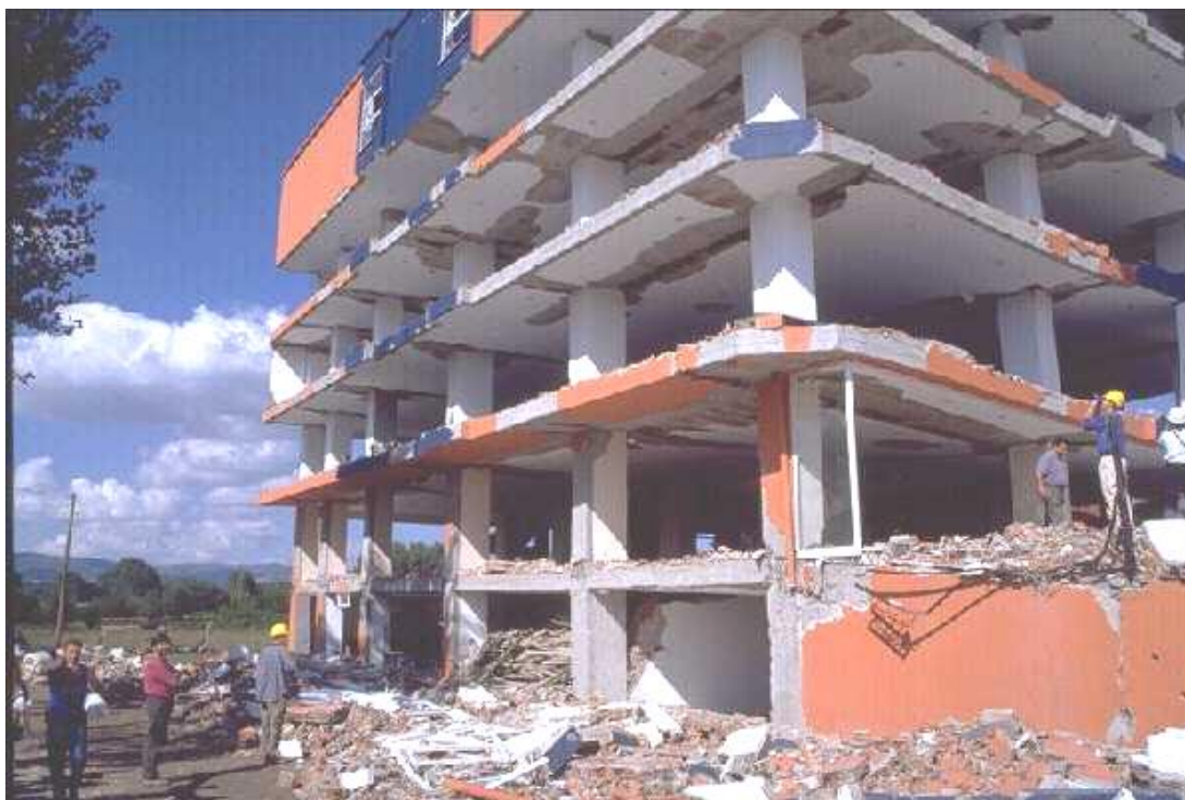
Foto 6.46: Evaluación de daños en estructura luego de un sismo.
