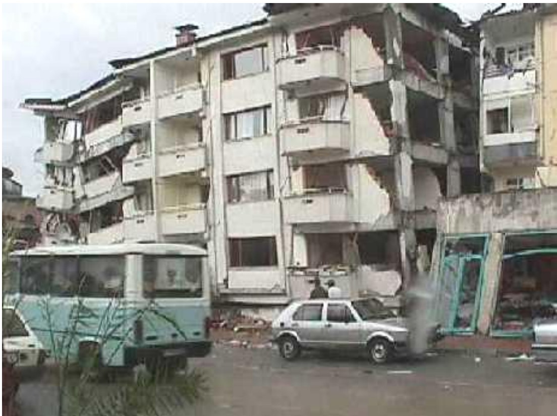
Foto 3.3: Edificio con daños considerables en los componentes estructurales y no estructurales.
