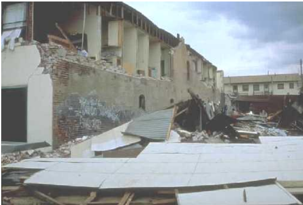
Foto 7.31: Edificaciones colapsadas de mampostería no confinada.
