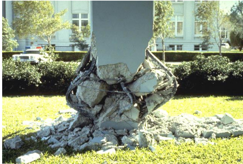
Foto 6.25: Columna del edificio de las fotos anteriores, acercamiento de la falla en la parte inferior de la columna en la esquina sudeste del edificio. La falla ocurrió en la zona de la columna donde no hubo confinamiento adecuado del hormigón y refuerzo de acero para corte.
