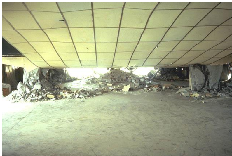
Foto 6.21: Vista interior del edificio de la foto 6.20, mostrando el colapso del segundo piso debido a la falla de corte de las columnas del segundo piso. Notar el desplazamiento lateral significativo (deriva de entre piso hacia la derecha) debido a la rotación torsional de la parte superior del edificio.
