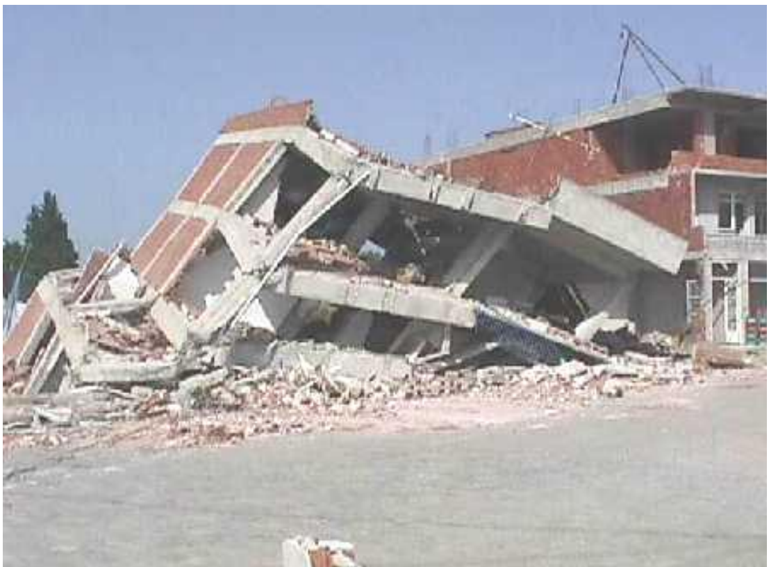
Foto 6.9: Colapso total del edificio.
