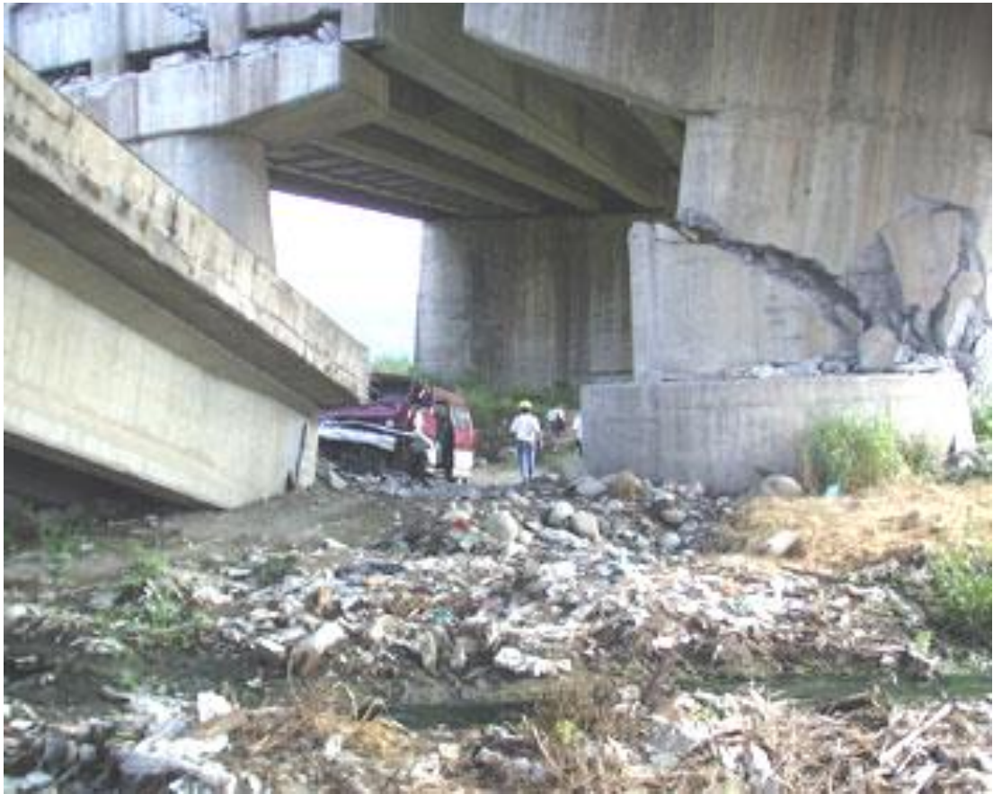
Foto 7.16: Pilas de puente colapsado.
