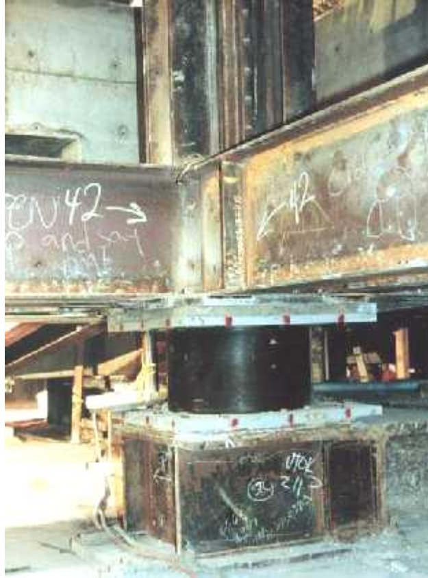
Foto 4.10: Aislador de base en estructura metálica.
