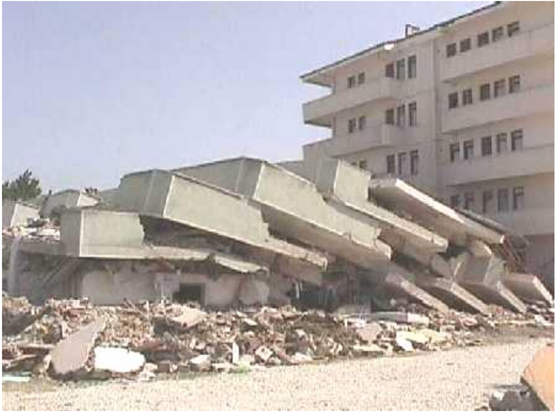
Foto 6.8: Colapso total del edificio.
