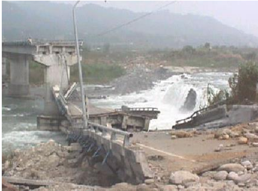
Foto 7.18: Pilas de puente colapsado.
