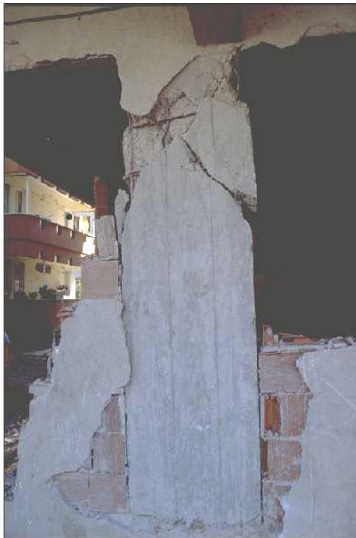
Foto 6.28: Falla por columna corta.
