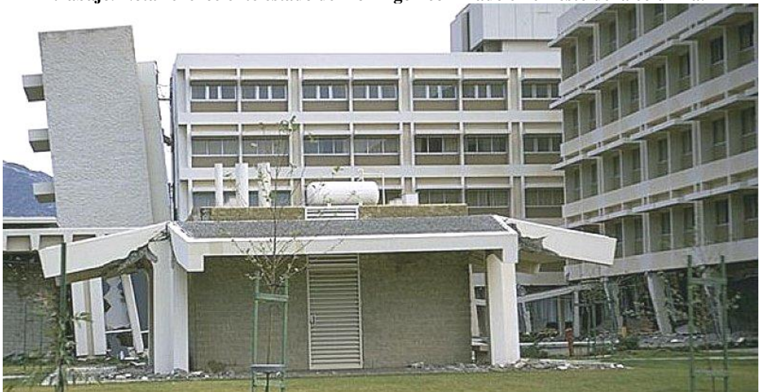
Foto 3.12: Hospital Olive View, San Fernando, California. Vista parcial de los 5 pisos de Tratamiento Médico y Unidad del Cuidado (a la derecha y atrás de la foto), el corredor, y el primer piso del Edificio de Asamblea (al lado izquierdo de la foto) ilustrando el daño que estos edificios sufrieron durante el terremoto de San Fernando en 1971.
