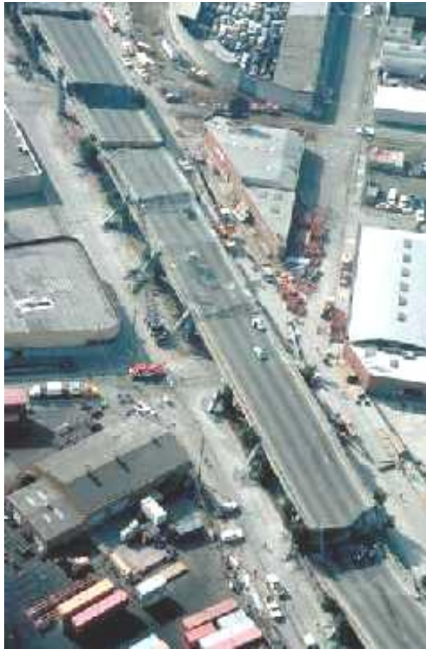
Foto 7.20: Puente colapsado en la ciudad.
