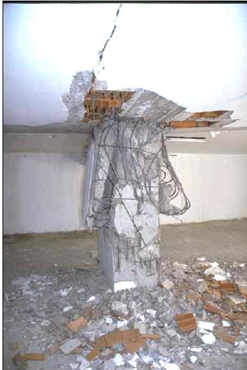
Foto 6.42: Refuerzo transversal de columnas de hierro liso. Falla axial en la planta baja, columna exterior en el terremoto localizado a 5 Km del este del Golcuk, Izmit (Kocaeli), Turquía, magnitud 7.4, Agosto 17 de 1999.
