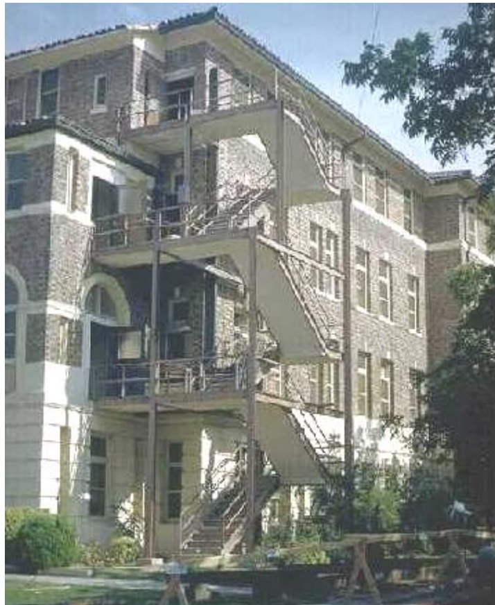
Foto 3.8: Hospital de la foto 3.7. Notar los apoyos de acero sosteniendo al edificio junto; no hay daño más allá del reportado en esta área después de los apoyos instalados.
