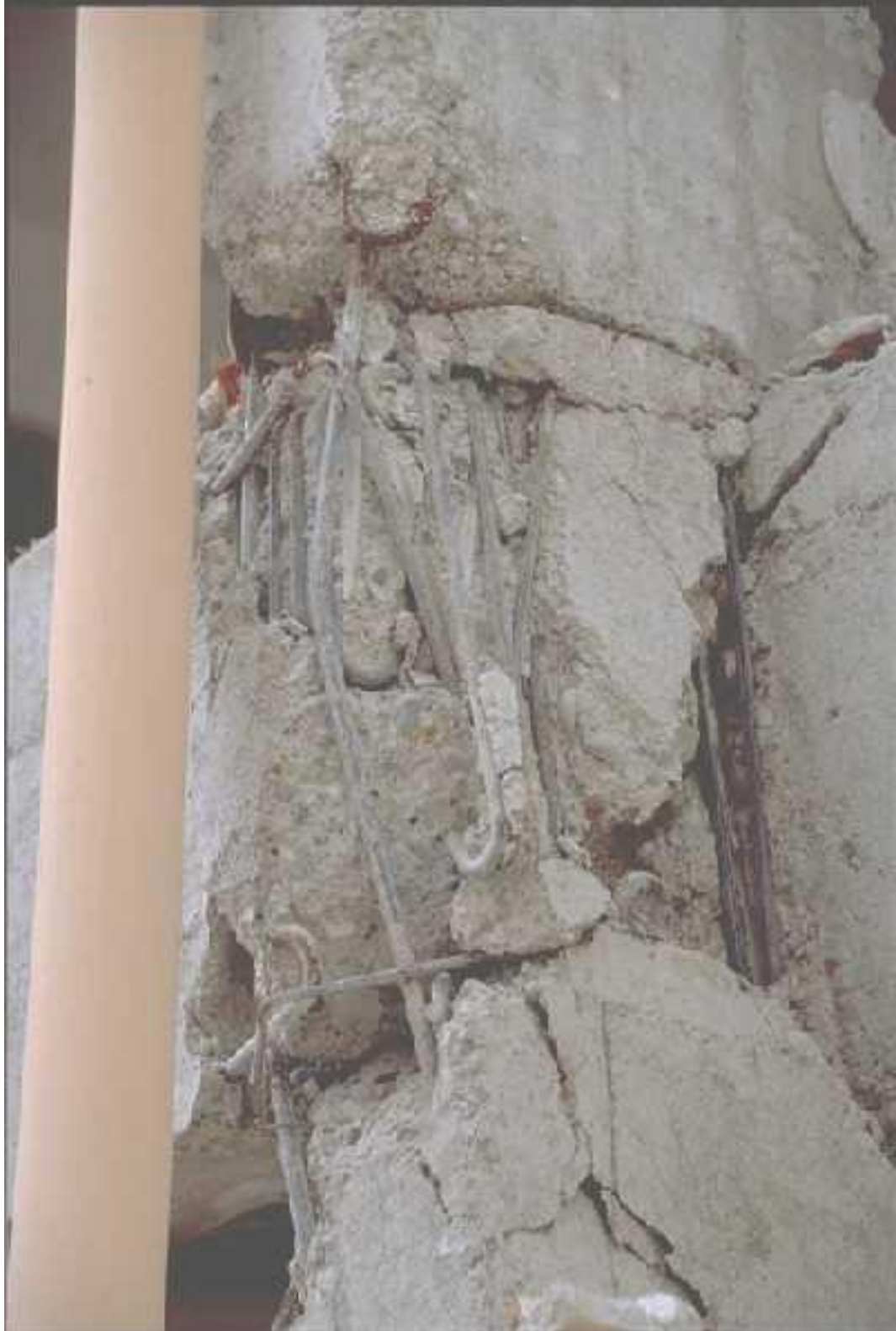
Foto 6.36: Falla unión viga-columna (nudo).
