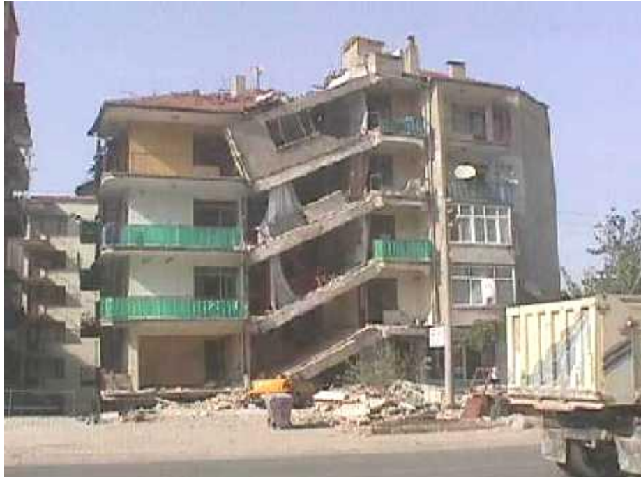
Foto 3.4: Edificio con daños considerables en los componentes estructurales y no estructurales.
