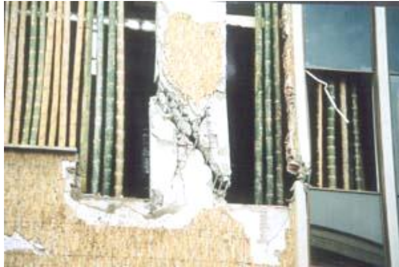
Foto 7.14: Edificio con falla en la columna por corte.
