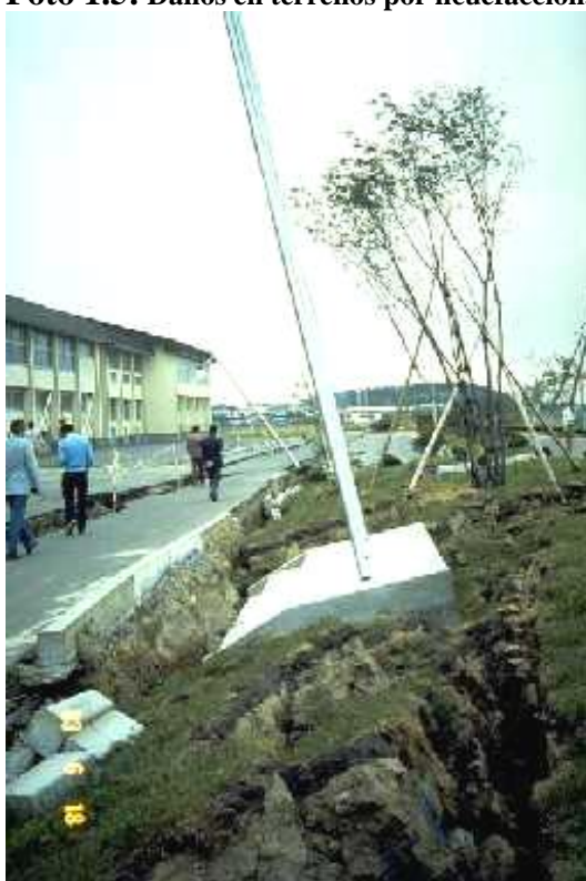
Foto 1.6: Daños en estructuras por licuefacción. Inclinación del asta de la bandera de la escuela debido a la falla del suelo causada por licuefacción durante el terremoto de Nihonkai-Chubu en 1983.
