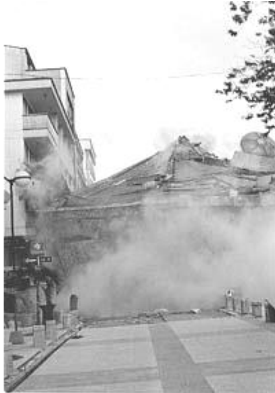
Foto 6.5: Secuencia de colapso total (3).
