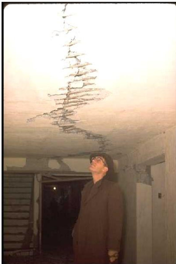
Foto 6.35: Falla en la losa.
