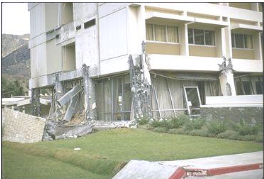
Foto 6.31: Columnas perimetrales débiles.
