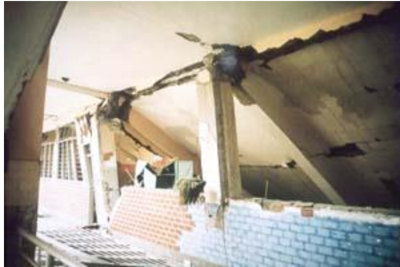
Foto 6.37: Edificio con falla en unión viga-columna (nudos).
