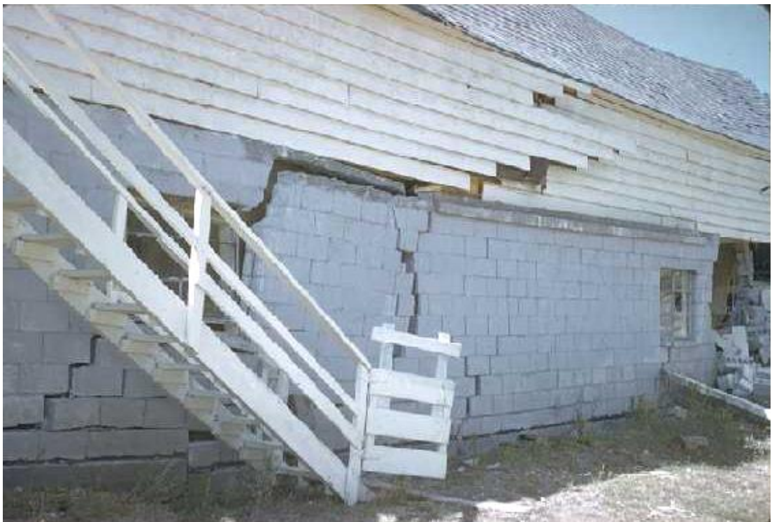
Foto 7.25: Colapso de un edificio de mampostería de bloque sin confinar.
