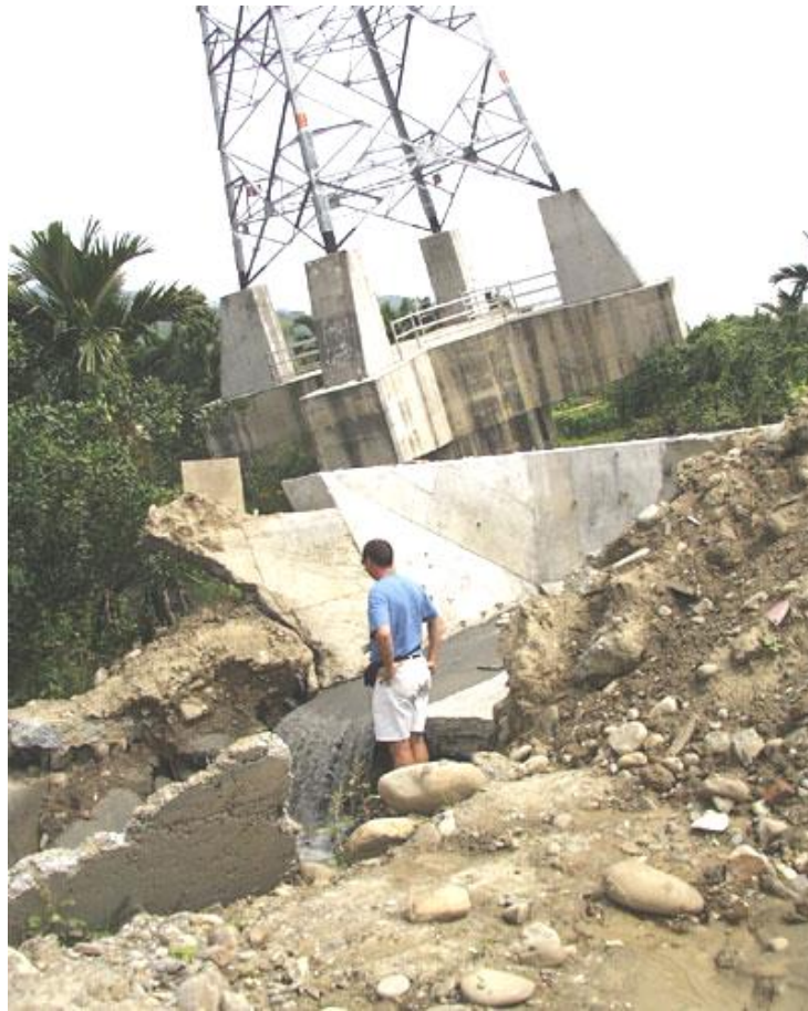
Foto 7.22: Torre de energía colapsada.
