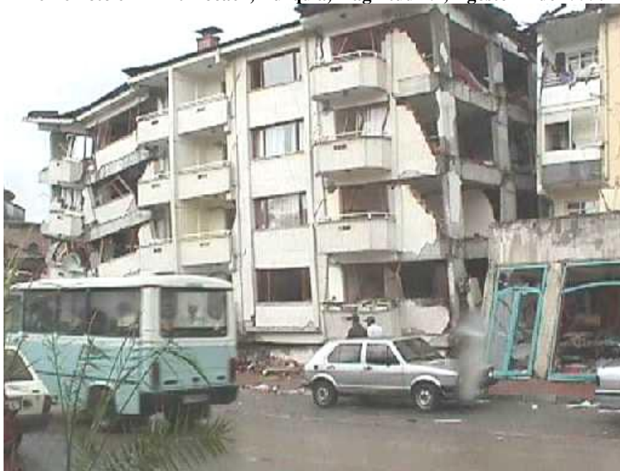
Foto 6.30: Falla en pisos superiores.
