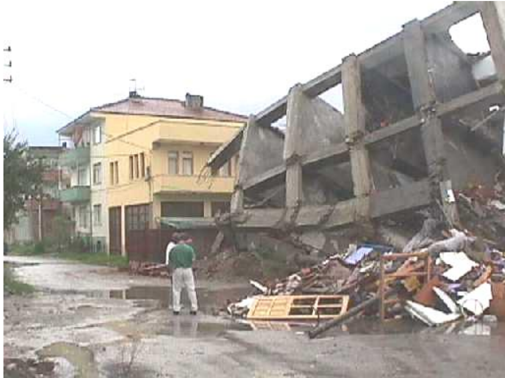
Foto 6.12: Colapso total del edificio.
