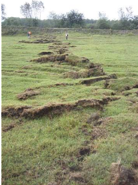
Foto 1.5: Daños en terrenos por licuefacción.
