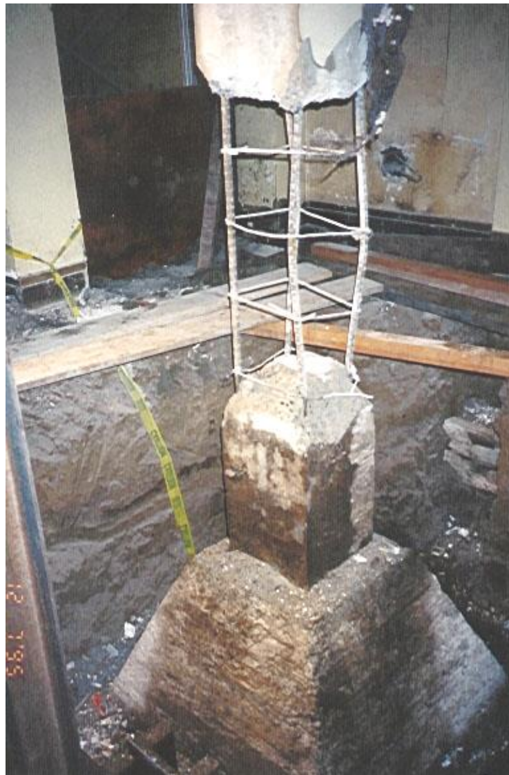
Foto 6.33: Deficiencias en el refuerzo transversal.
