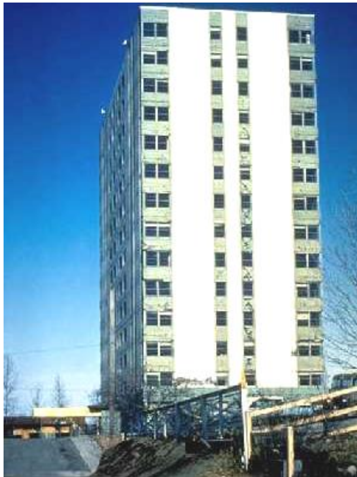
Foto 3.1: Edificio con daños menores después de un terremoto.
