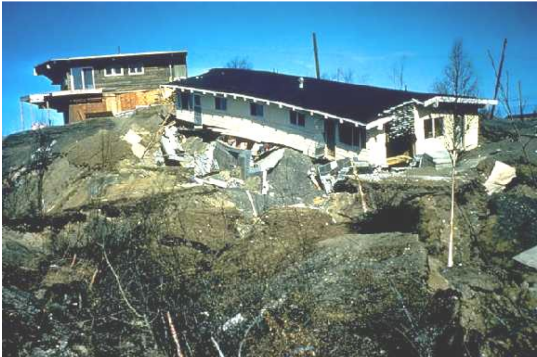
Foto 1.2: Daños en estructuras por licuefacción.
