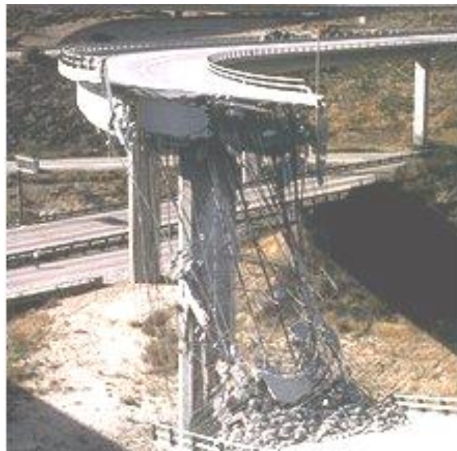
Foto 7.17: Puente curvo que colapsó.
