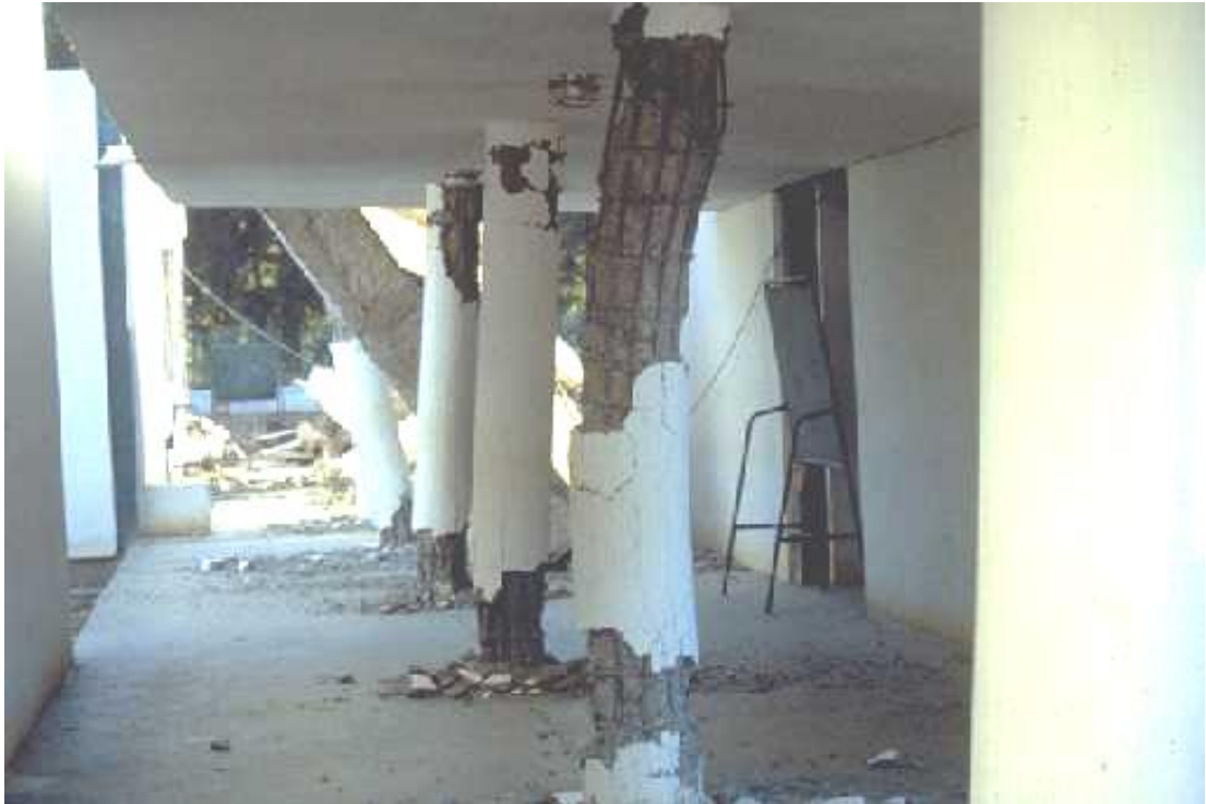
Foto 6.17: Fallas en columnas por flexo-compresión y/o cortante.
