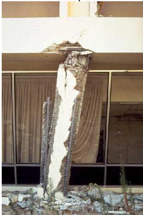
Foto 3.10: Vista global de una de las columnas del primer piso de la estructura anterior. Notar la interrupción (extremo) del refuerzo espiral antes de ser anclado en la viga y por lo tanto la falta de confinamiento del concreto en la región crítica de la columna.
