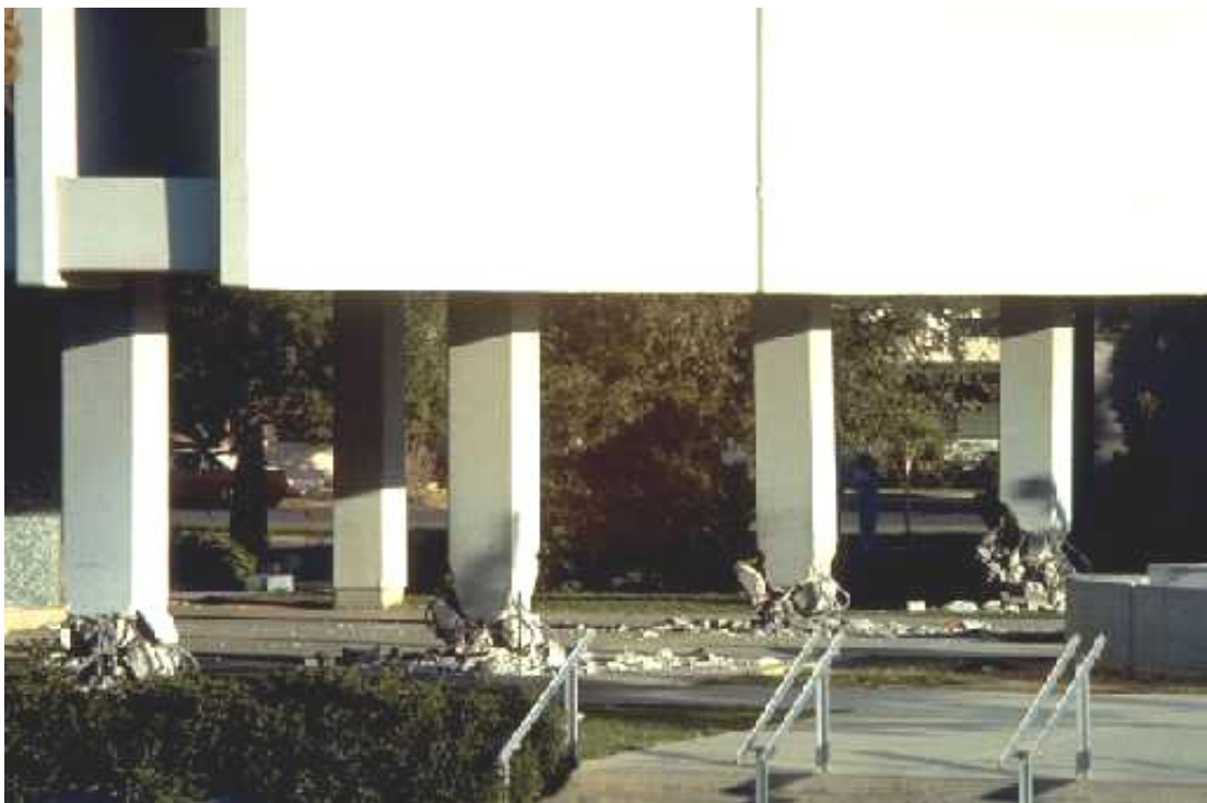
Foto 6.24: Edificio con daños en las columnas exteriores.
