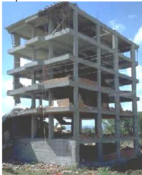
Foto 3.2: Edificio (bajo construcción) con falla en la columna esquinera debido al colapso del edificio adyacente. Notar la losa del techo del edificio adyacente descansando en la esquina del tercer piso. Localizado a 5 Km al este Golcuk, Izmit (Kocaeli), Turquía, de magnitud 7.4, 17 de Agosto de 1999.
