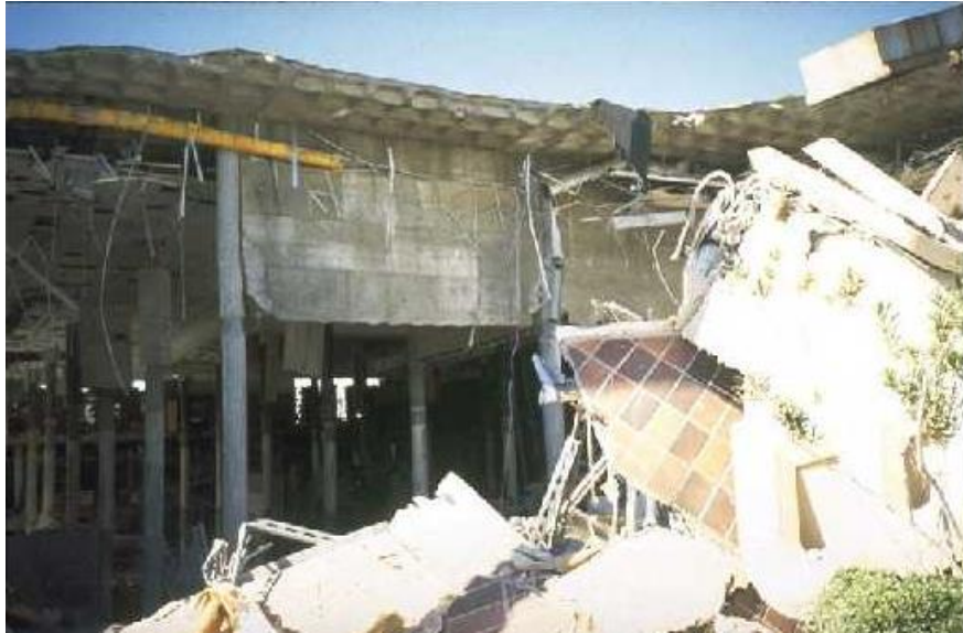
Foto 6.34: Falla en la losa.
