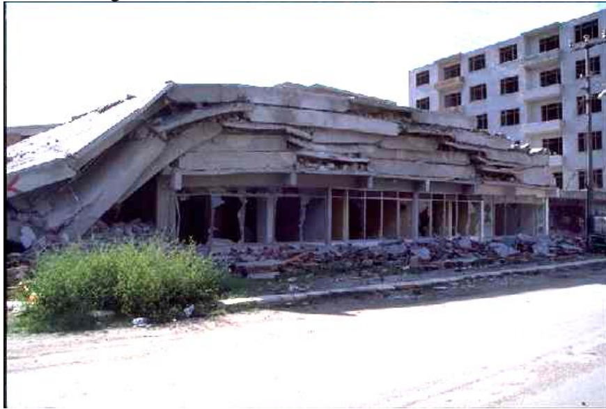
Foto 6.29: Fallas en pisos superiores. Terremoto en Izmit Kocaeli, Turquía, magnitud 7.4, Agosto 17 de 1999.
