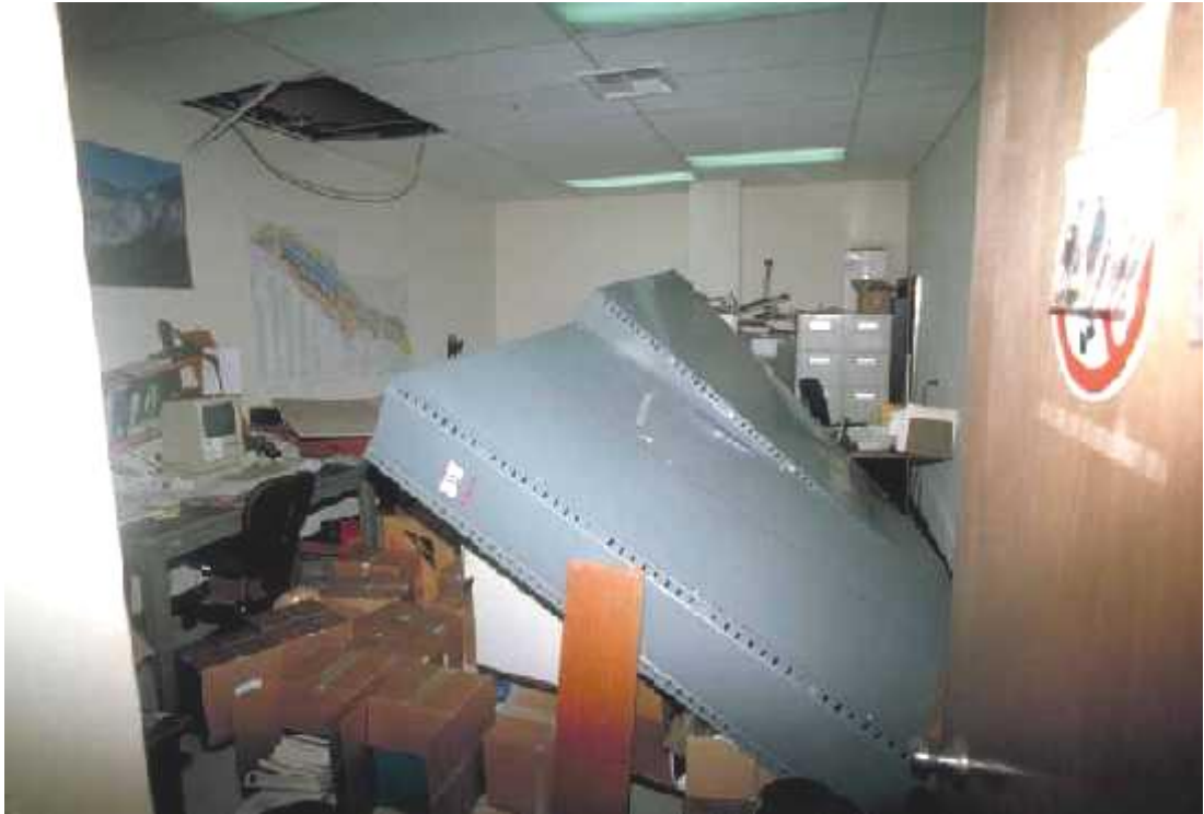
Foto 7.30: Daños en el interior de un edificio.
