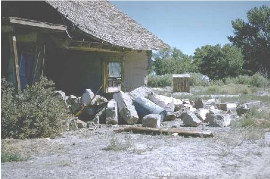
Foto 7.24: Construcción de adobe en el campo, colapsada después de un terremoto.
