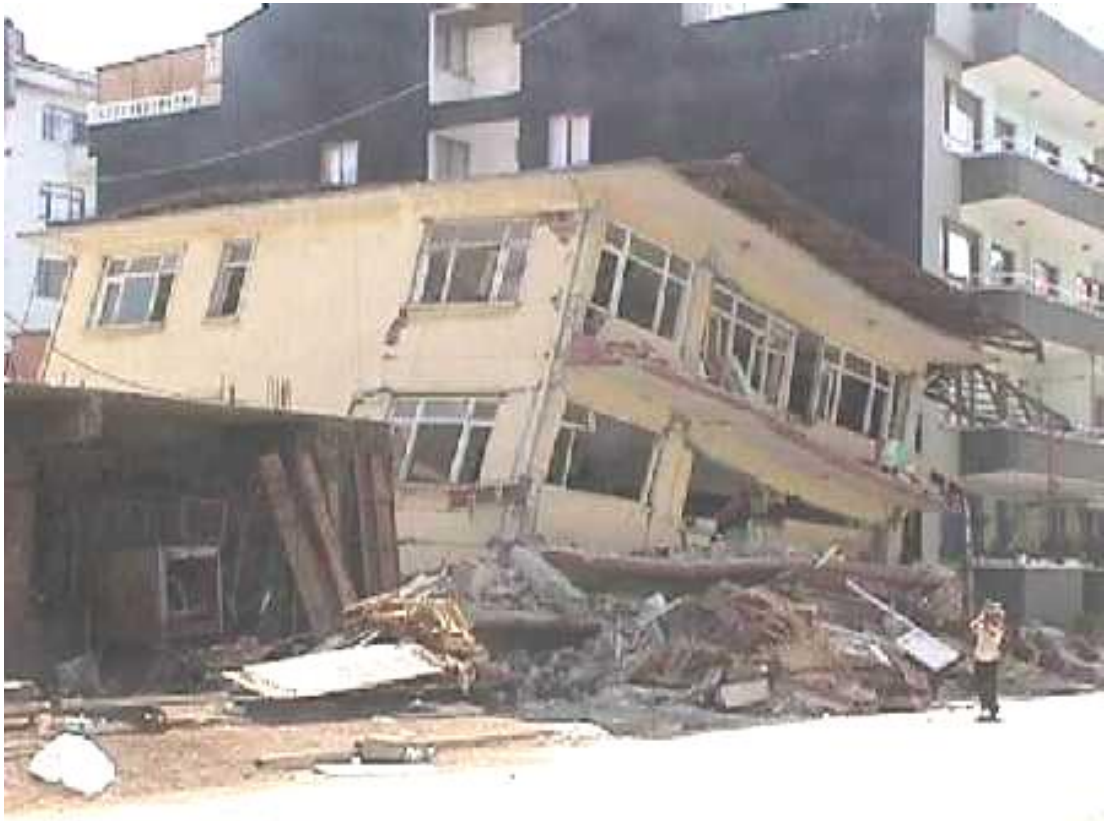
Foto 6.10: Colapso total del edificio.
