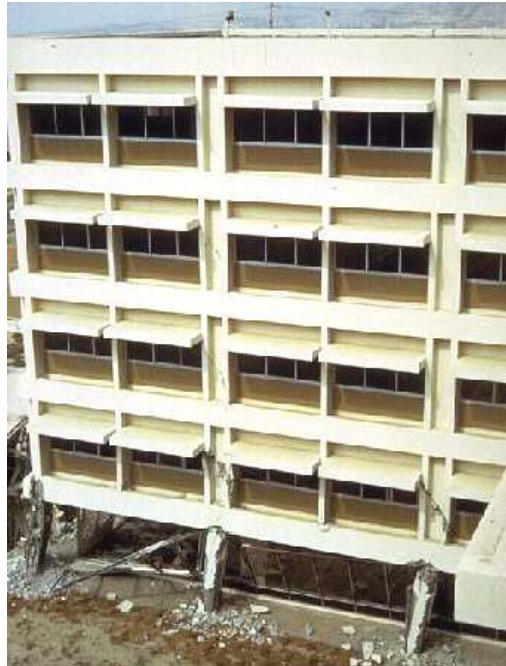
Foto 3.9: Vista del hospital Olive, Tratamiento Médico y Unidad del Cuidado, 1971 terremoto de San Fernando. Vista del extremo de una de las cuatro alas de este edificio de 5 pisos de concreto reforzado después del terremoto.
