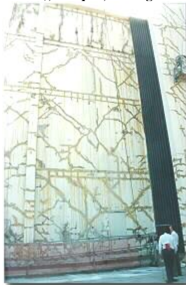
Foto 6.15: Daños estructurales menores (fisuramiento).
