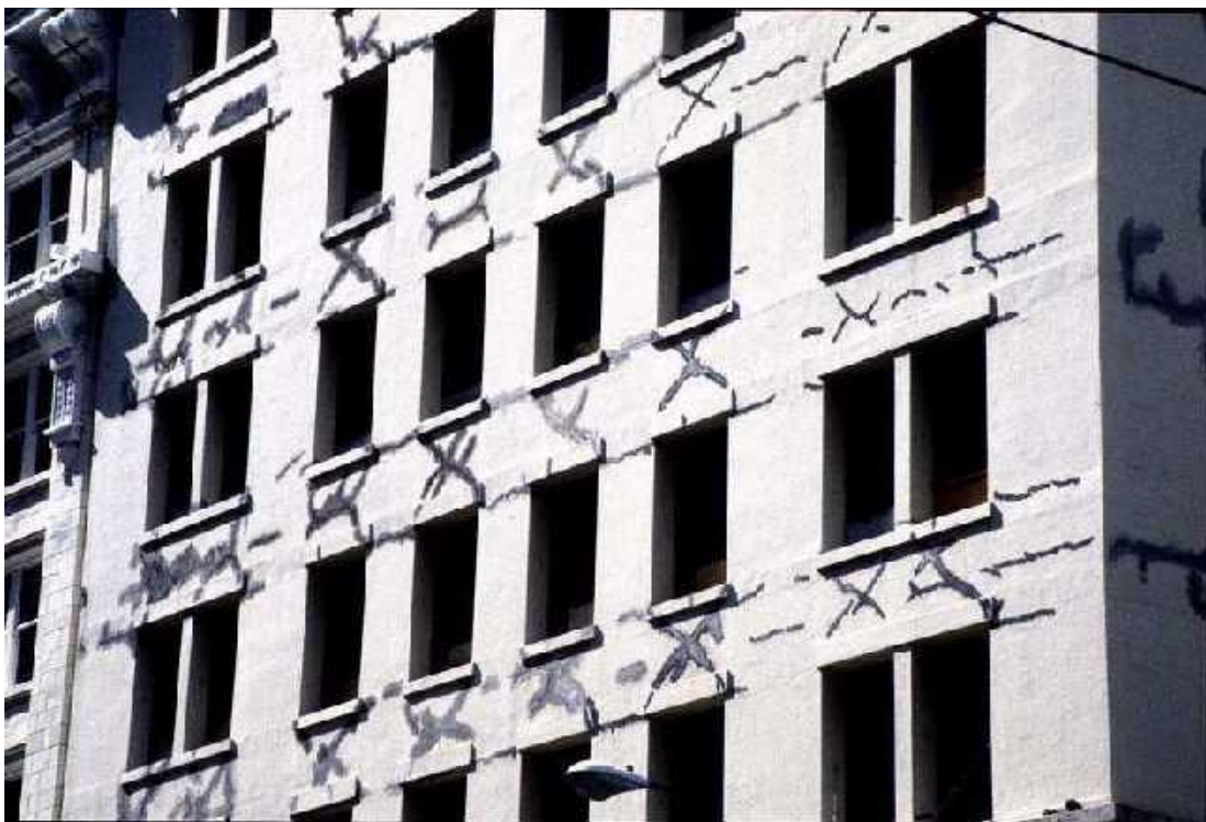
Foto 4.1: Edificio con fallas provocadas por un sismo.
