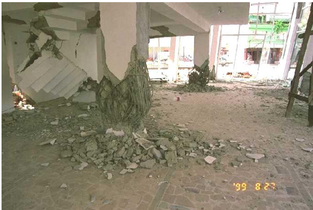
Fotos 3.5: Edificio parcialmente destruido debe ser demolido. Izmit, (Kocaeli), Terremoto de Turquía, 17 de Agosto de 1999, Magnitud 7.4.
