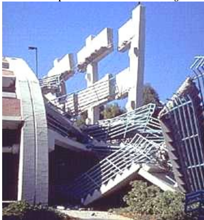
Foto 6.45: Estructura parcialmente dañada.
