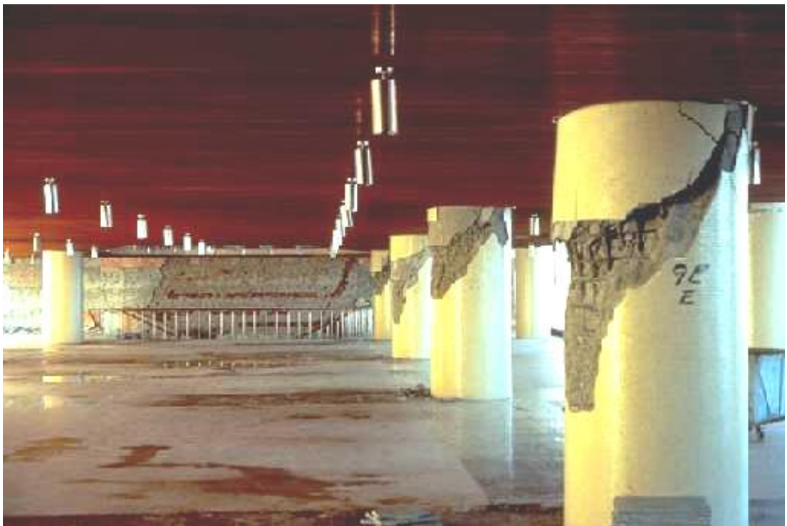
Foto 6.18: Fallas en columnas por flexo-compresión y/o cortante.
