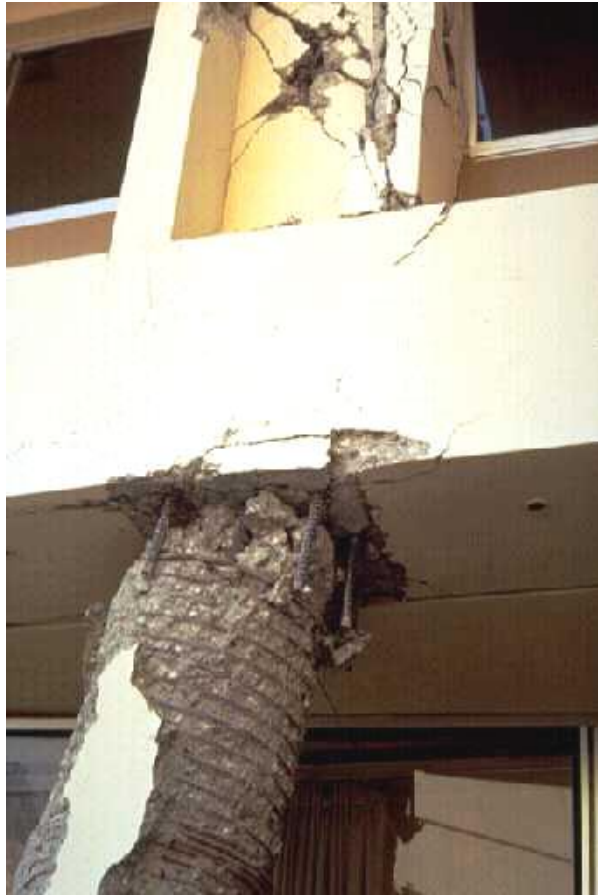
Foto 3.11: Acercamiento de la parte superior de la columna mostrada en la foto 3.10, ilustrando claramente cómo el concreto en esta región ha sido roto como consecuencia del prematuro (pronta) final del refuerzo en espiral. La inspección buena del refuerzo antes de poner el encofrado y los lanzamientos del hormigón deberían haber detectado este pobre trabajo. Notar el excelente estado del hormigón confinado en el resto de la columna.
