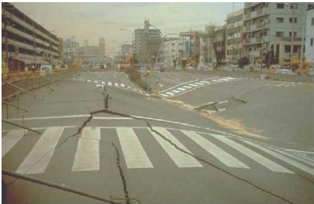
Foto 7.21: Rotura de la superficie de la calle causada por un terremoto al dañar los túneles cerca de la estación de Daikai, en Kobe.
