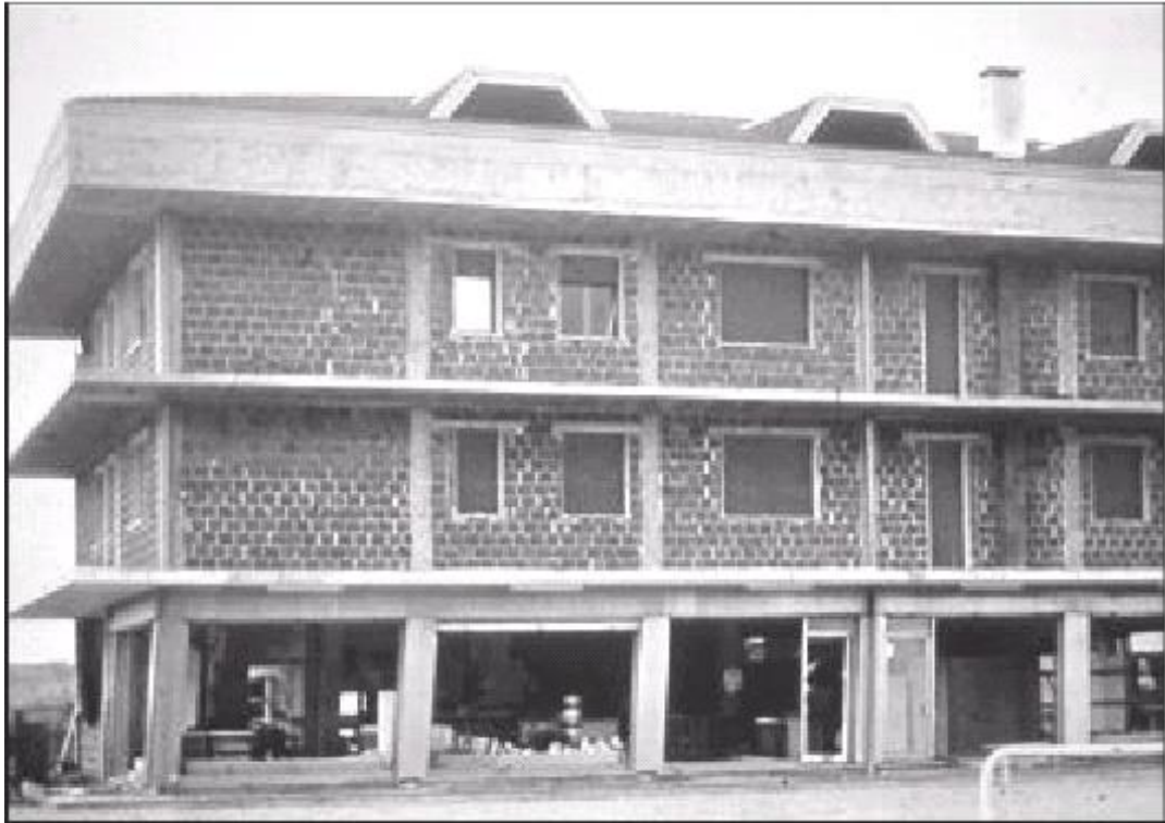
Foto 7.2: Falla debido a piso blando. La interrupción de elementos verticales (paredes y columnas) de la estructura ha sido la causa de colapsos parciales o totales en edificios sujetos a terremotos, especialmente cuando esto ocurre en los pisos más bajos. El nivel en que los elementos se interrumpen es más flexible que los otros, que aumenta el problema de la estabilidad, pero también porque el cambio brusco en relaciones de rigidez, una acumulación más grande de energía en el piso más débil. Los casos más comunes de la interrupción de elementos verticales, que ocurre generalmente para razones espaciales, formales o estéticas, es lo siguiente: • la interrupción de las columnas • la interrupción de paredes estructurales (paredes de corte) • la interrupción de paredes de división (erróneamente concebido como paredes de no estructurales) alineado con los marcos.
