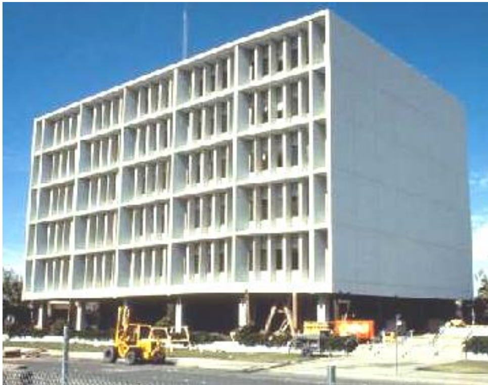
Foto 7.6: Edificio con daño en la columna esquinera.
