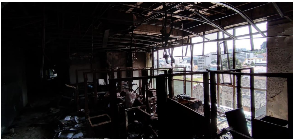
Ilustración 14: Piso 5, zona afectada por el incendio Fuente: CEE
