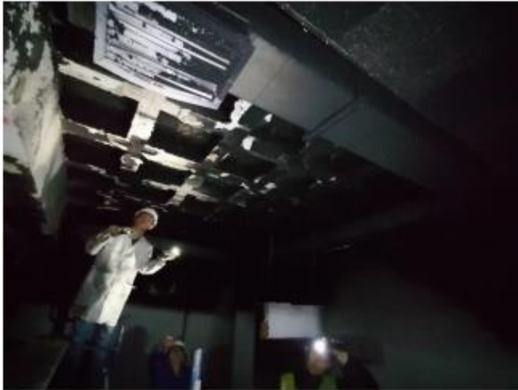
Ilustración 15: Piso 5, cajetines afectada por el incendio
