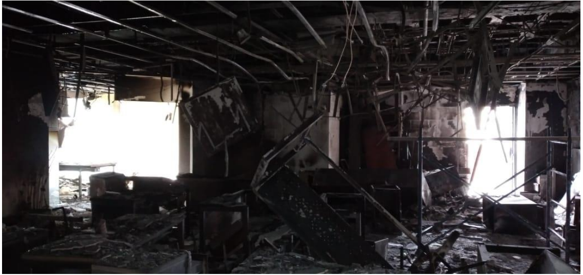
Ilustración 13: Piso 4, zona altamente afectada por el incendio Fuente: CEE
