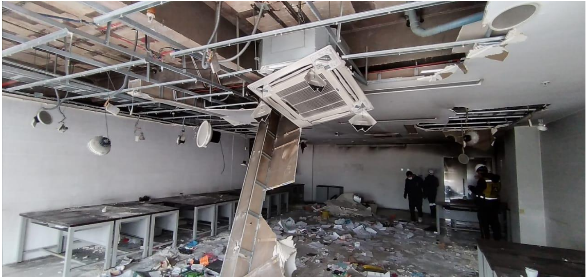
Ilustración 18: Piso 4 oficinas afectadas por el incendio Fuente: CEE
