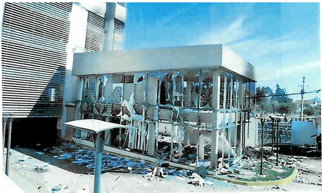
Ilustración 10: Edificio de la Contraloría después del incendio
