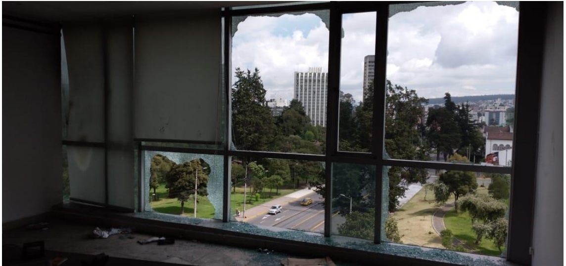
Ilustración 16: Piso 5 lado norte, zona afectada por el incendio Fuente: CEE
