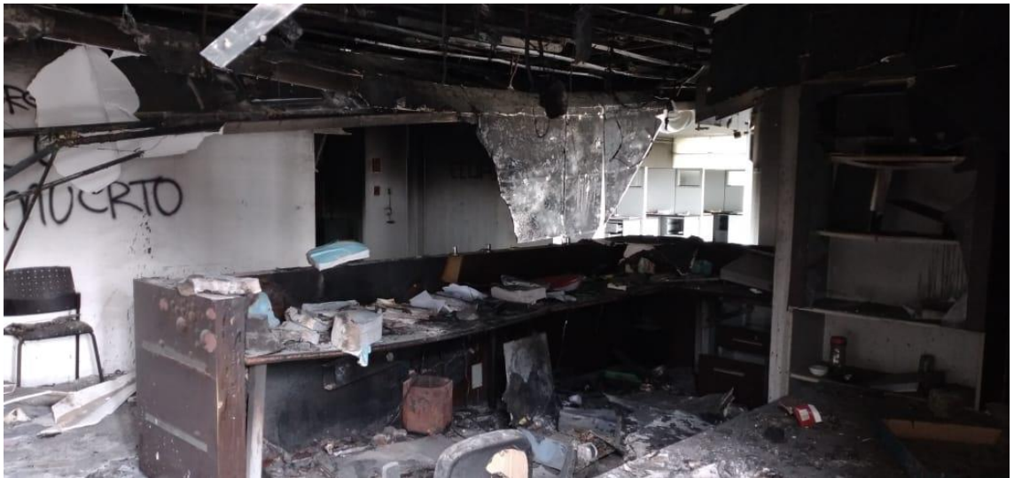
Ilustración 17: Piso 4 zona afectada por el incendio Fuente: CEE
