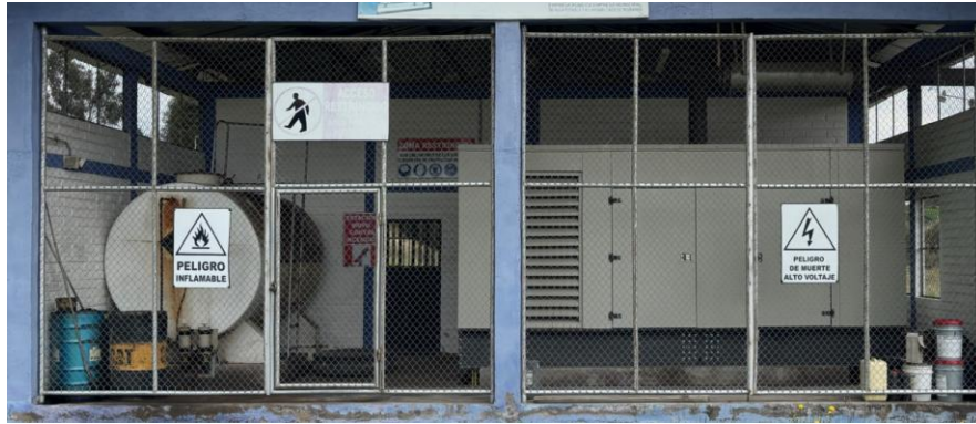
Figura 4. Generador de emergencia en el sistema de Llio.
