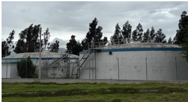
Figura 8. Tanques de la reserva Los Álamos.
