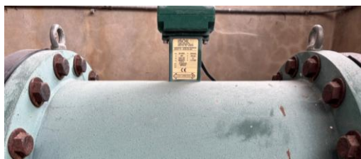
Figura 11. Caudalímetro ubicado en la tubería a la salida de los tanques de reserva hacia la red de distribución.
