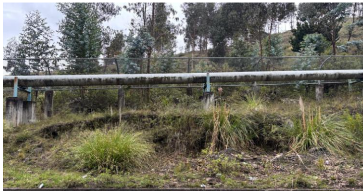
Figura 3. Línea de conducción del sistema de captación.
