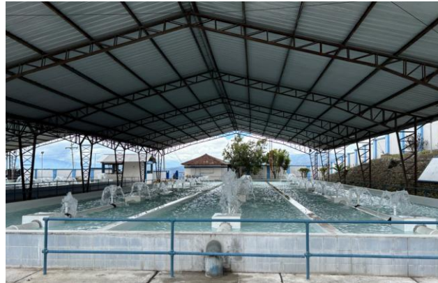
Figura 6. Piscinas de aireación por aspersion.
