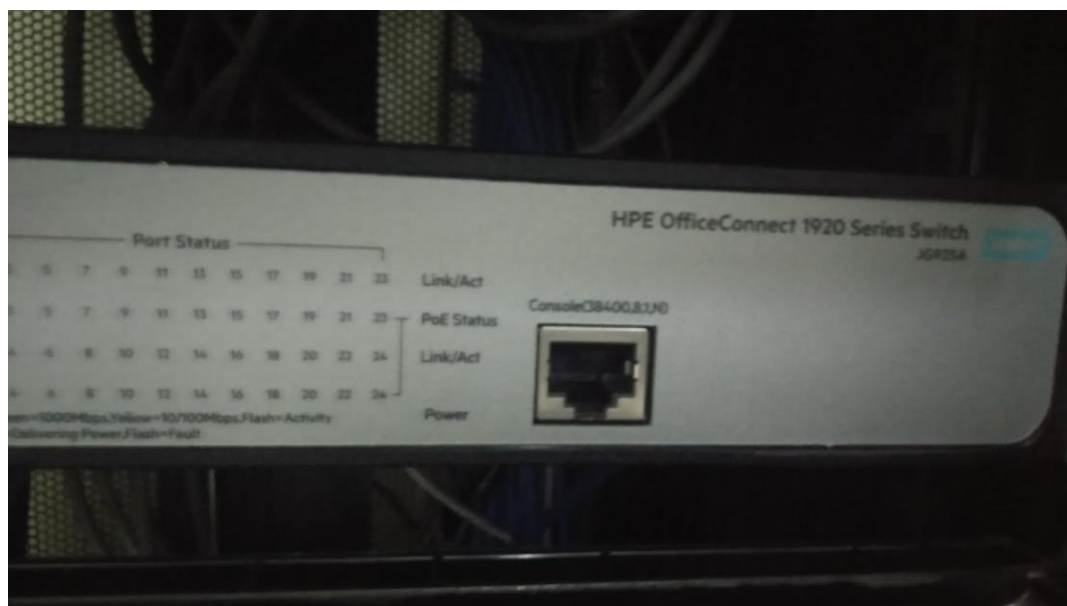
Grafica 8: Switch instalado en Patronato Municipal
