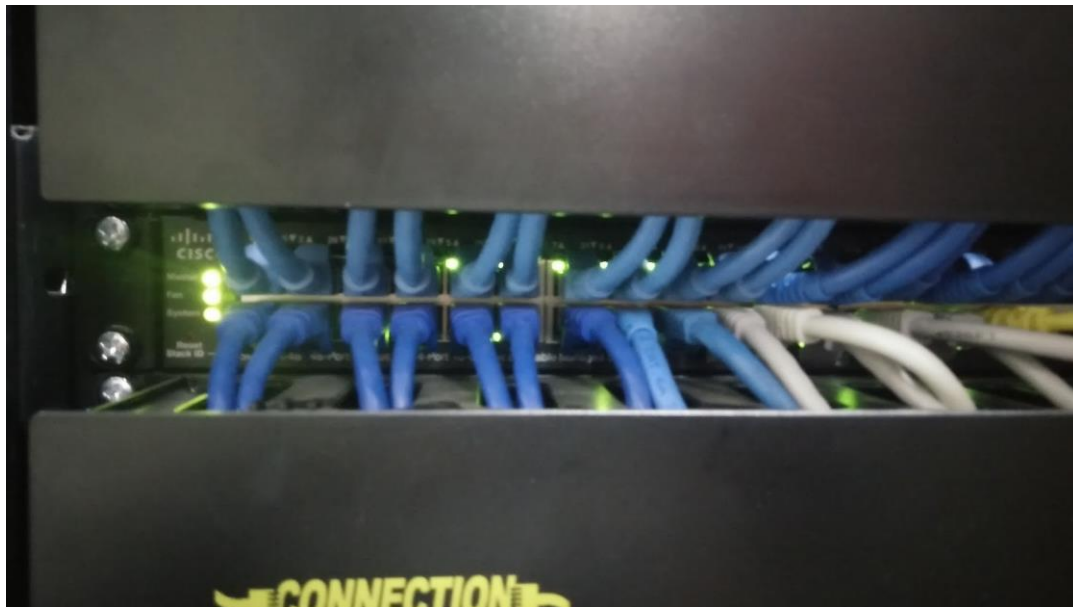
Grafica 1: Switch principal en Edificio Administrativo
