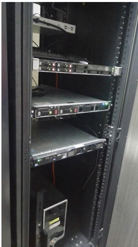
Grafica 4: Rack de servidores en el Edificio Administrativo
