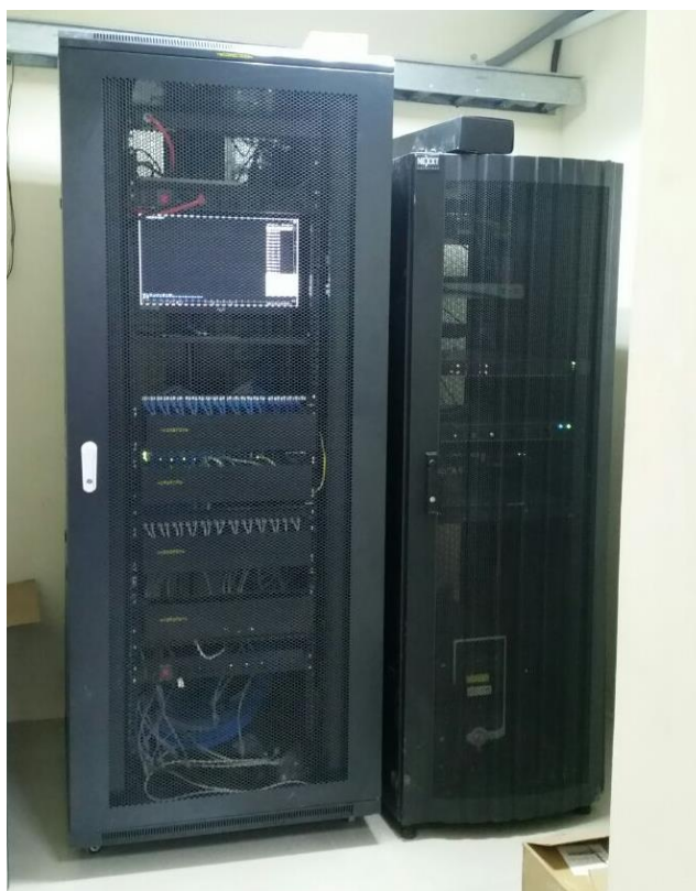
Figura 4: Cuarto de Telecomunicaciones Elaborado por: Autor de la tesis
