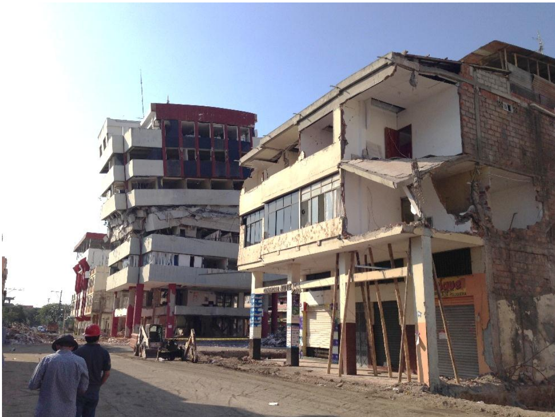
Ilustración 1: Edificaciones afectadas por el terremoto del 16 de abril de 2016
