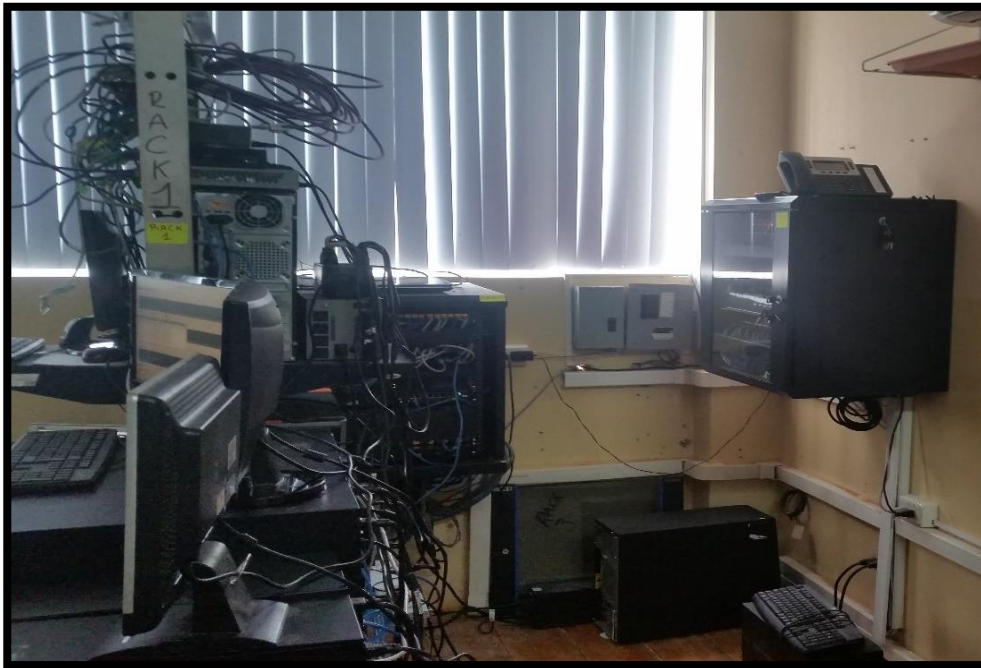
Figura 15: Rack 01 y Rack 02 - FCI Elaborado por: Autora de Tesis
