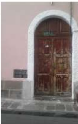
IMAGEN 7. Fachada en mal estado en San Marcos.
