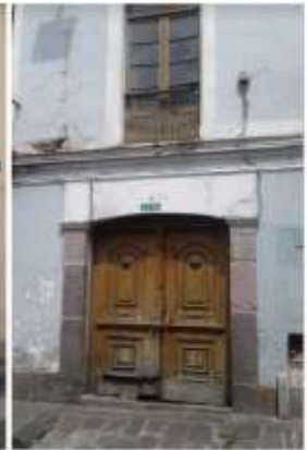
IMAGEN 4. Fachada en mal estado en San Marcos.
