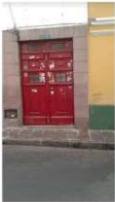
IMAGEN 5. Fachada en mal estado en San Marcos.
