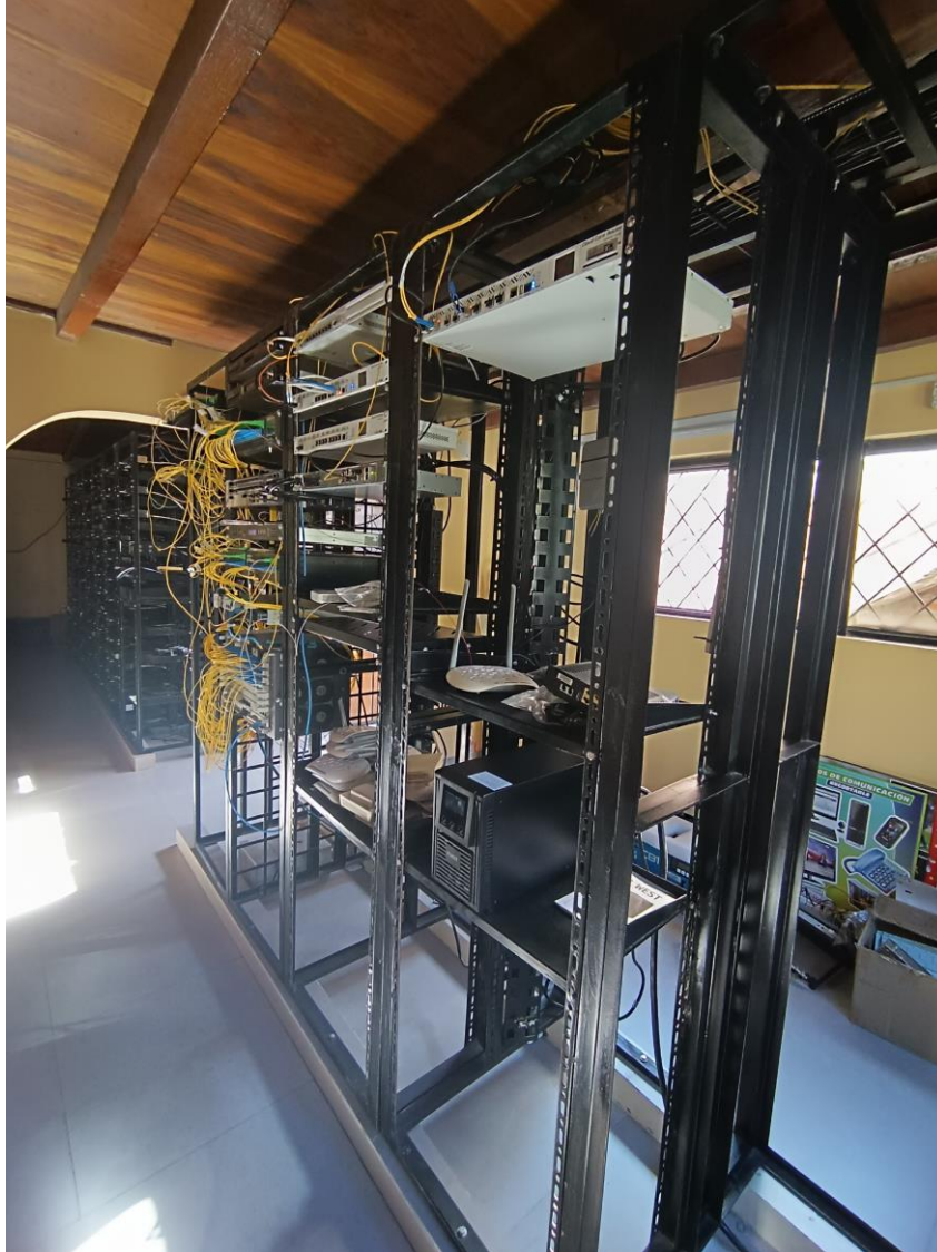
Ilustración 7: Disposición de racks en Imbabunet
