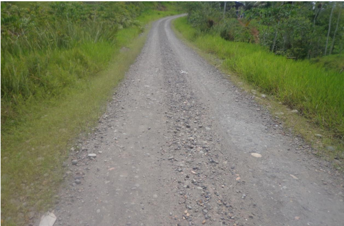
Figura 1.3 Estado actual de la vía principal de acceso a la Comunidad de San Isidro
